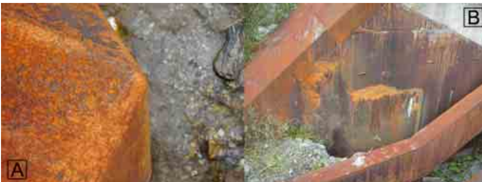
Abb. 23: Korrosion von Baustahl (Sauerstoffkorrosion): (A) Flächen- bzw. Muldenkorrosion; (B) verstärkte Stahlkorrosion in Abrasionsbereichen
