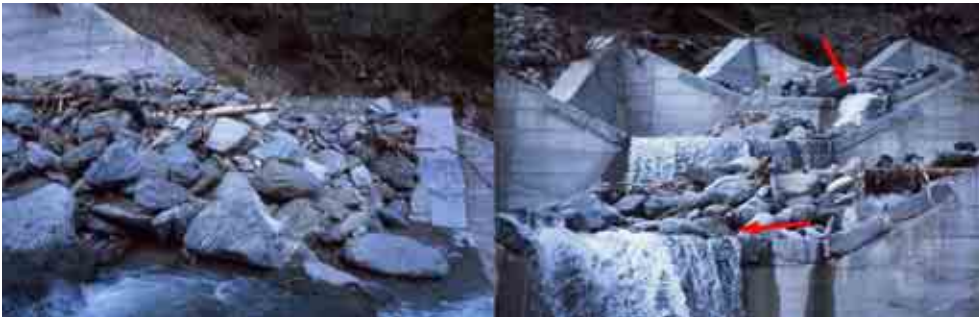
Abb. 12: Auflandung im wasserseitigen Sperrenvorfeld und Verlagerung der Bachachse an den Gewässerrand
