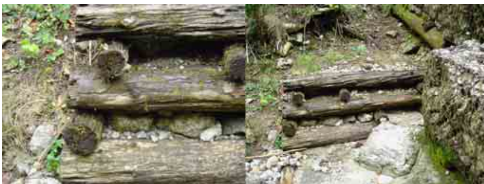
Abb. 26: Moderfäule aufgrund ständiger Durchfeuchtung (Baujahr 1975)
