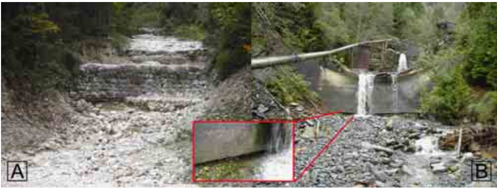
Abb. 7: Auskolkung aufgrund rückschreitender Tiefenerosion: (A) Zerstörter Kolktschutz einer Steinsperre (ZMWK); (B) fehlende untere Einbindung einer Stahlbetonsperre
