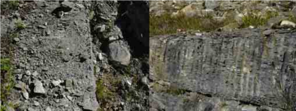
Abb. 28: Frostverwitterung an einer Sperrrenkrone
