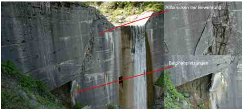
Abb. 14: Hangdruck: Versagensmechanismus 2 (lokales Druckversagen): Lokales Druckversagen des Betons mit ausgeknickten Bewehrungsstäben und Betonabplatzungen.
