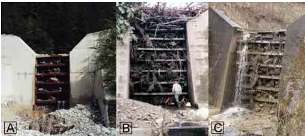
Abb. 6: Verklausungen: (A) durch Geschiebe; (B) durch Wildholz; (C) Vdurch Geschiebe und Wildholz Fig. 6: Blockages: (A) due to bedload, (B) due to deadwood; (C) due to deadwood and bedload
