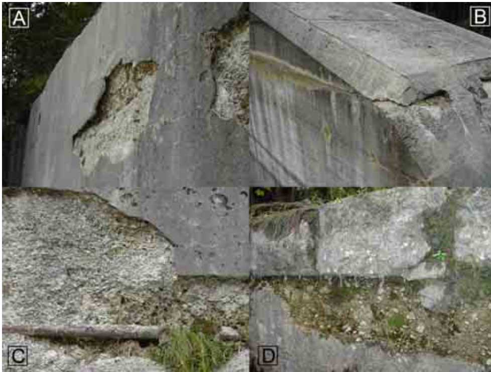
Abb. 21: Frostverwitterung an Betonsperren: (A) plattenförmige Abplatzungen (Baujahr 1929); (B) Frosssprennung an einer Betonierfuge im Kronenbereich (Baujahr 1996); (C) Verwitterung im Bewehrungsbereich aufgrund Frostverwitterung und Karbonatisierungsinduzierter Korrosion (zu geringe Betondeckung; Baujahr 1929); (D) Verwitterung unmittelbar unter Kronsteinen
