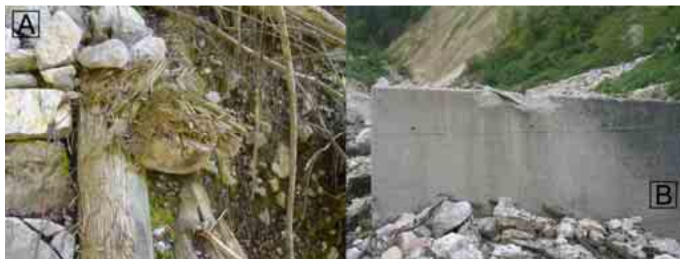
Abb. 4: Abrasion mit hohem schlagendem Anteil: (A) Hydroabrasion auf Holz; (B) Abrasion einer Stahlbetonkrone im seitlichen Flügelbereich
