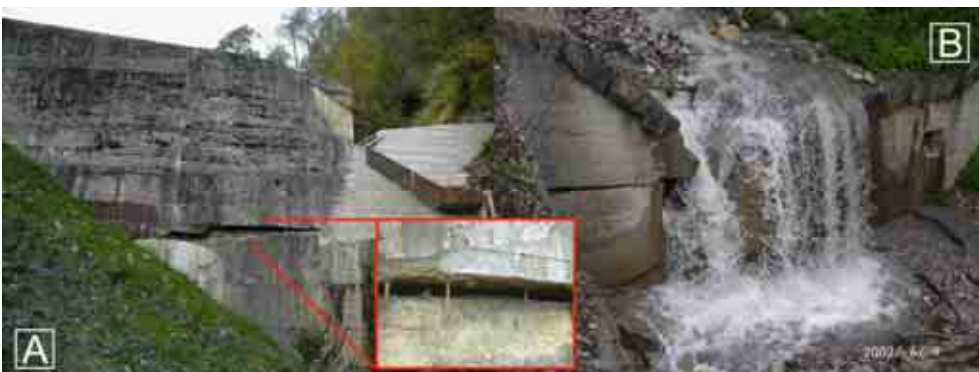
Abb. 13: Hangdruck: Versagensmechanismus 1 (Schubversagen): (A) Abscheren des Flügels an einer horizontalen Fuge (Trennriss) mit anschließender Verkantung; (B) Abscheren mit Verkantung und Verdrehung
