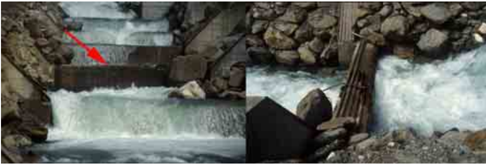
Abb. 17: Unterspülung einer Konsolidierungssperre Fig. 17: undercutting of ceckdam
