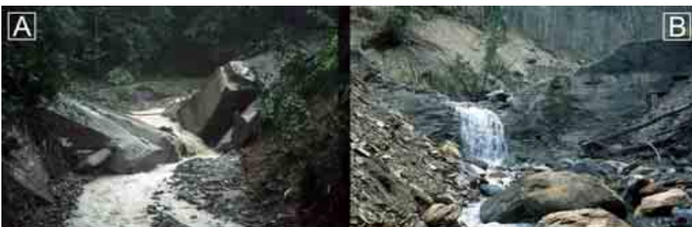
Abb. 18: Zerstörung von Sperren: (A) Totalschaden; (B) Zerstörungen der Sperrenkrone mit anschließender Abrasion des Sperrenkörpers Fig. 18: total loss of dams
