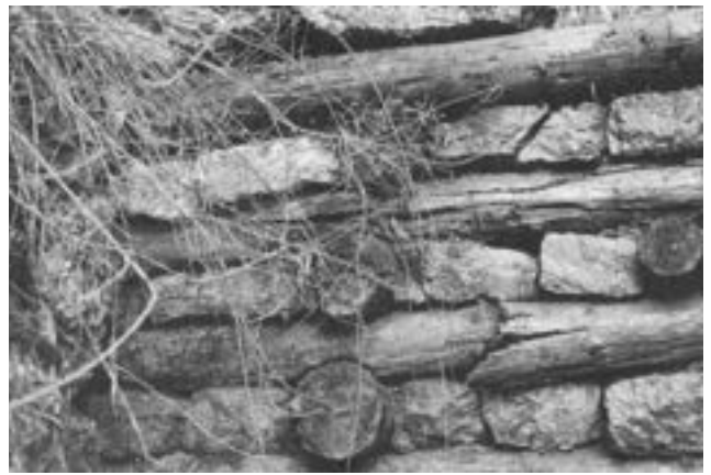
Bruch der Längshölzer durch beginnende Bauwerksverformung (SKL K)
