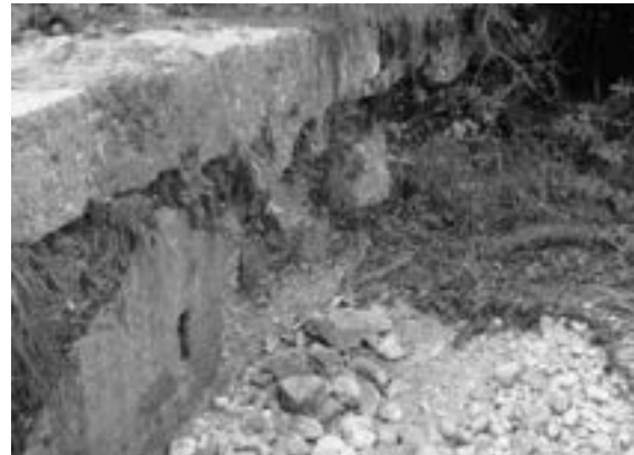
Bewuchs von vorgeschädigten, verwitterten Bereichen durch Gräser und Kräuter (Mauerkörper als Substrat) (SKL K) ©Suda
