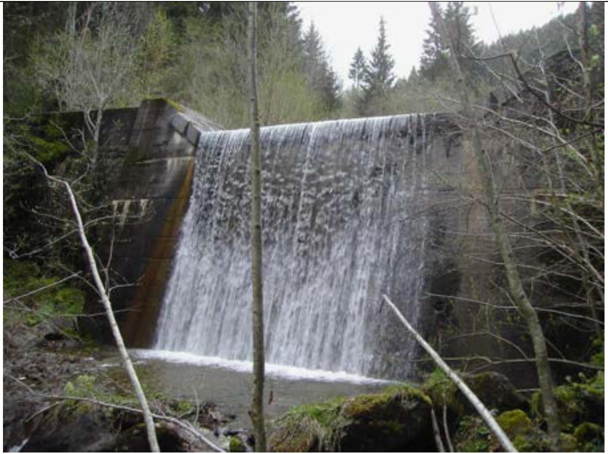
Abflussection, Breite der Vorsperre und Länge des Tosbeckens im Vergleich zur Hauptsperre zu gering dimensioniert (SKL K),©Suda
