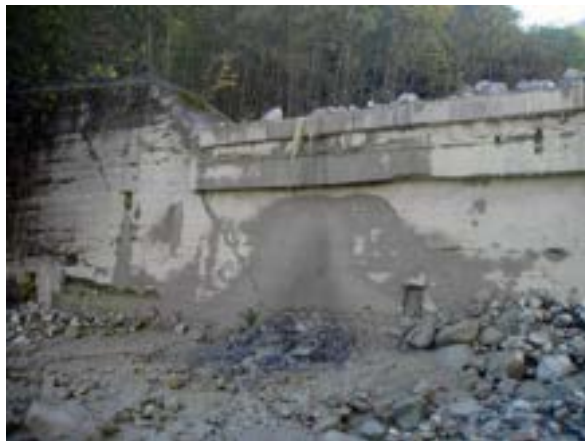
Setzungsriss (schräge Abtreppungsriss) in einer Gewichtssperre aus Beton (SKL K) ©Suda
