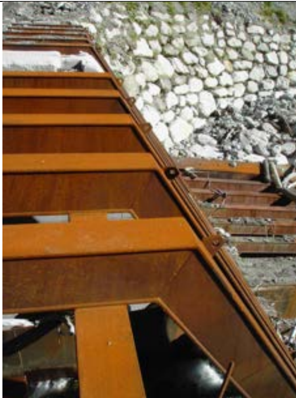
Korrodierte an Rechenkonstruktion (SKL U) ©Suda
