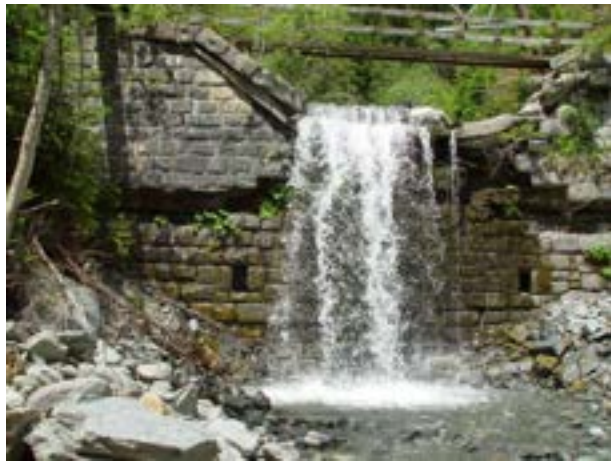
Verformung in der Folge von Überlastung durch seitlichen Hangdruck (SKL K) ©Suda
