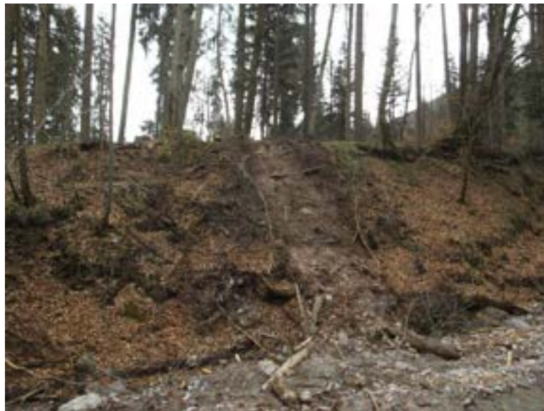
Erodierte Böschung (SKL K) ©WLV Tirol
