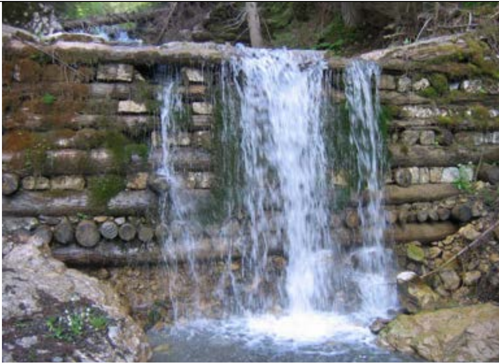
Freiliegender Schwerboden einer Holzkastensperre (SKL K) ©Suda
