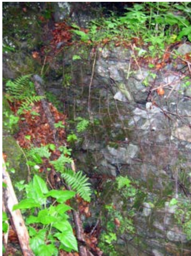
Verformtes Drahtgeflecht (SKL K) ©Suda
