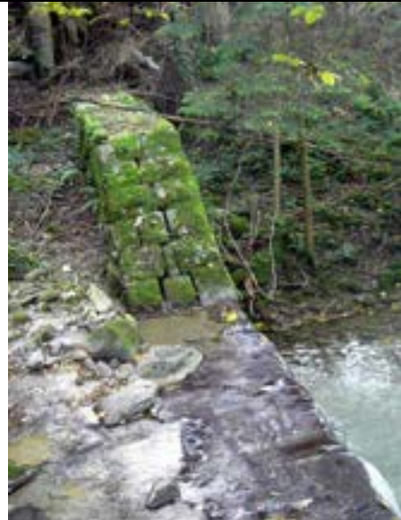
Großflächig fehlender Fugenmörtel(SKL H) ©Suda
