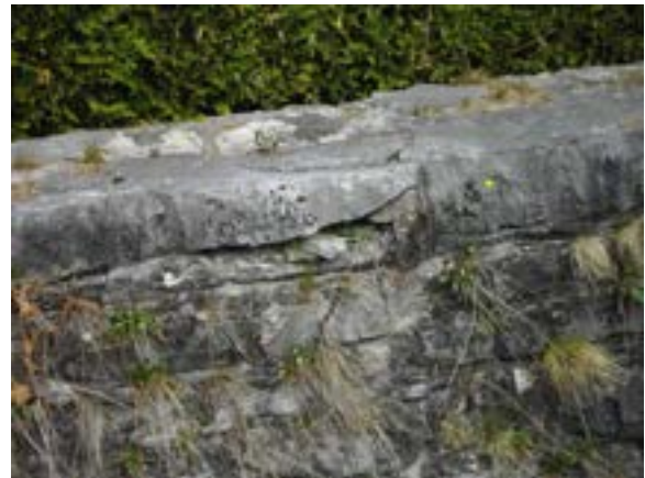
Abplatzungen am Mauerwerk (SKL K) © Suda
