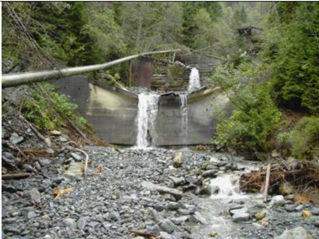
Unterkolkte Plattensperre aus Stahlbeton., seicht fundiert (SKL H) ©Suda
