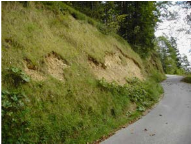
Erodierte Böschungsoberfläche (SKL K) ©Suda
