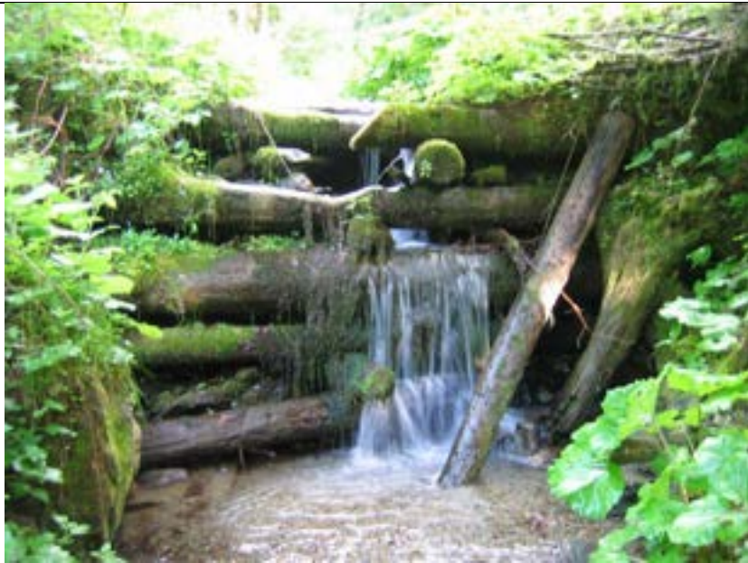
Ungehinderte Durchströmung des Sperrenkörpers (fehlende Ausfächung, Abtrag der Füllung) (SKL H) ©Suda
