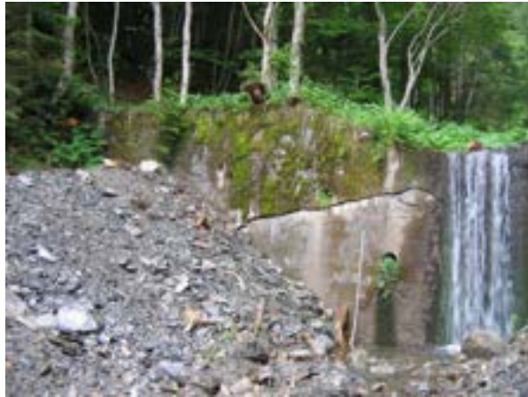
Risse infolge seitlichem Hangdruck an Betonbauwerken (SKL K) ©Suda
