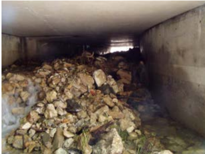
Geschiebeanlandungen unter einer Brücke (SKL H) ©WLV Steyr-Ennsgebiet
