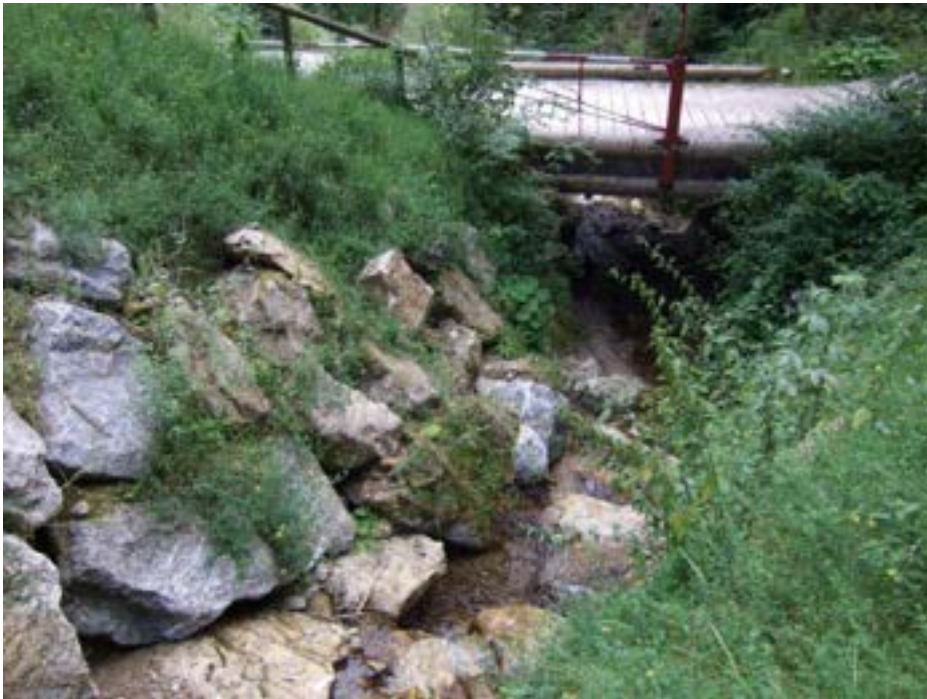
Zusammengesackte Grobsteinschichtung (SKL K) ©WLV
