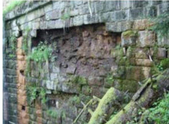
Abgeplatzte oberste Steinschicht bei Mischmauerwerk (SKL H) ©WLV
