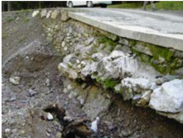
Freiliegende Unterkante einer Ufermauer (SKL K) ©Suda
