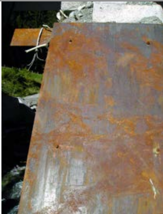
Korrodierte Kratzer von Geschiebe (SKL U) ©Suda
