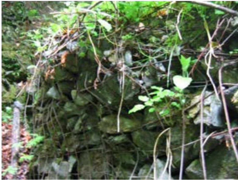
Verformtes Drahtgeflecht (SKL K) ©Suda
