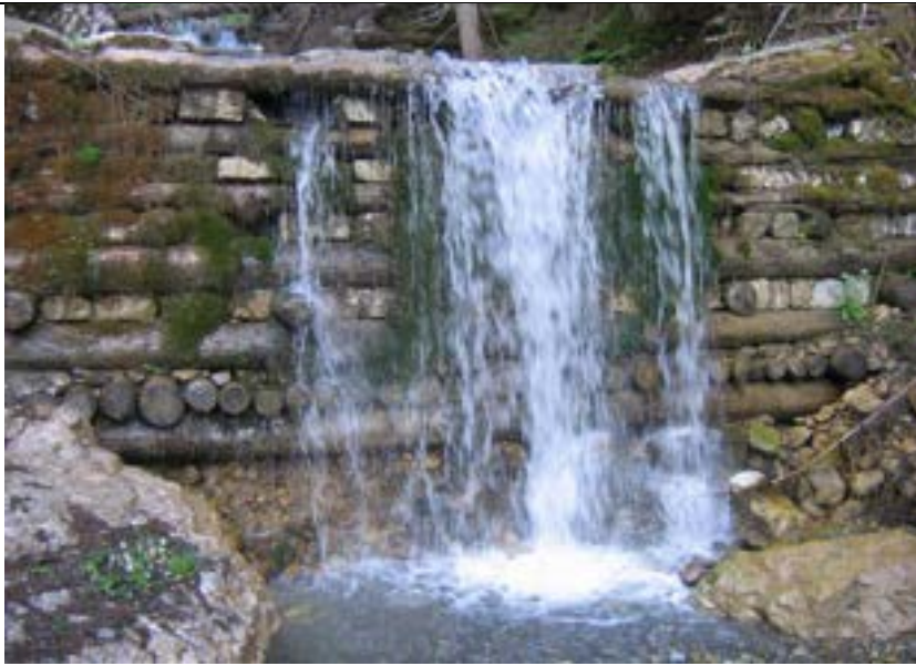
Durchströmung an punktuell fehlender Ausfächung, beginnende innere Erosion, Abtrag (SKL K) ©Suda
