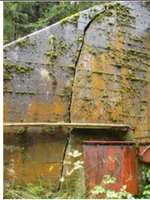
Trennriss infolge von Überlastung durch Erddruck an einer zu gering bewehrten Vorfeldwange einer Dosiersperre (SKL H) ©Suda
