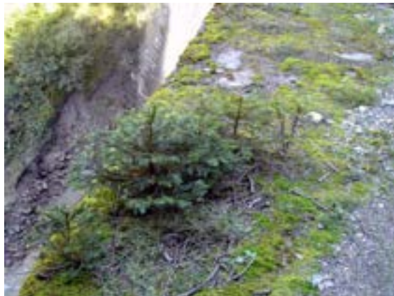
Bewuchs durch Jungbäume (Wurzeln sie in angewehem Substrat oder in den Mauerwerksfugen?); Fugenzustand darunter überprüfen ©Suda
