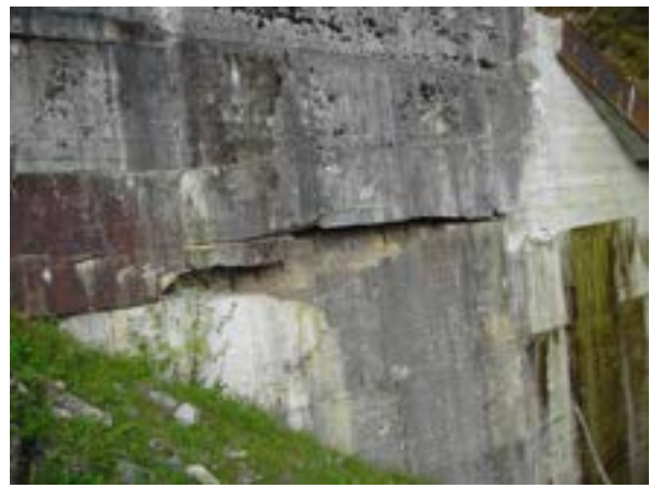
Risse infolge seitlichem Hangdruck an Stahlbetonbauwerken, gebrochene Bewehrungsstäbe (SKL H) ©Suda
