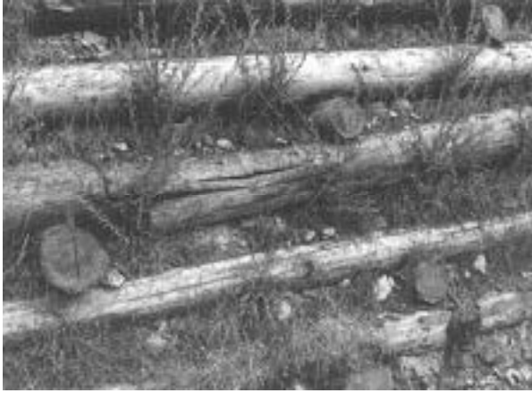
Risse in Längsbalken (SKL U)
