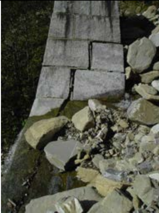
Trennriss im Flügel durch Bauwerksverformung infolge von seitlichem Hangdruck an Stahlbetonbauwerken (SKL K) ©Suda
