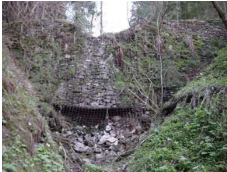
Abtrag der Füllung infolge einer Beschädigung des Drahtgeflechts (SKL H) ©WLV
