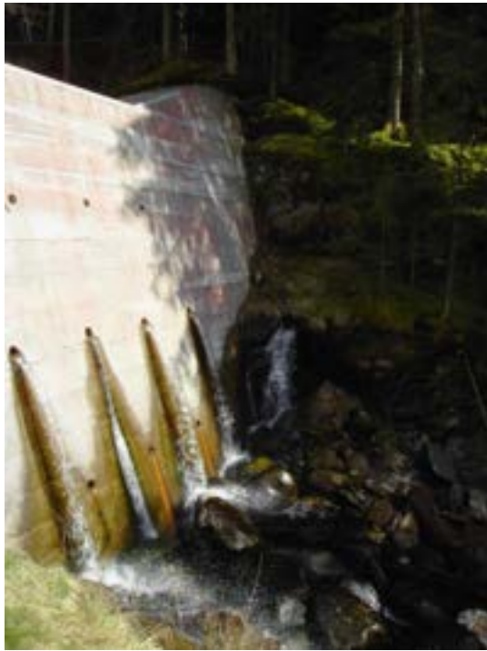
Punktförmige Durchströmung im Bereich der seitlichen Einbindung (SKL U) ©Suda
