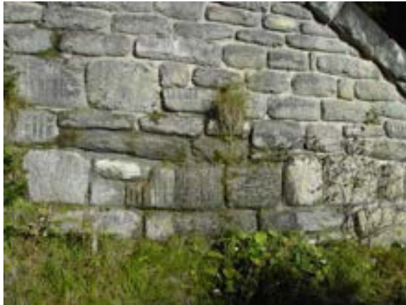
Durchfeuchtete Stellen können Hinweise auf Schädigungen sein ©Suda
