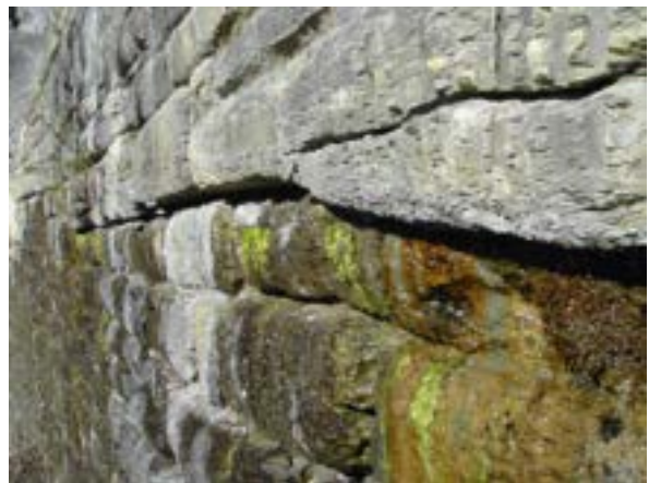
Riss aufgrund von seitlichem Hangdruck (Abscheren in Höhe der Abflusssektion) (SKL K) ©Suda
