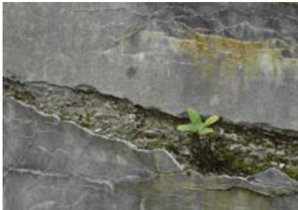
Bewuchs nach eines Betonbauwerks entlang einer Abplatzung (SKL U) ©Suda
