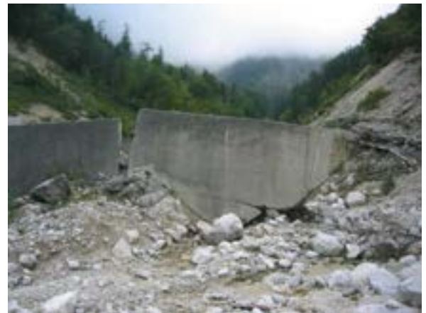
Bruch im Flügel infolge von fehlendem seitlichem Widerstand (SKL H) ©Suda
