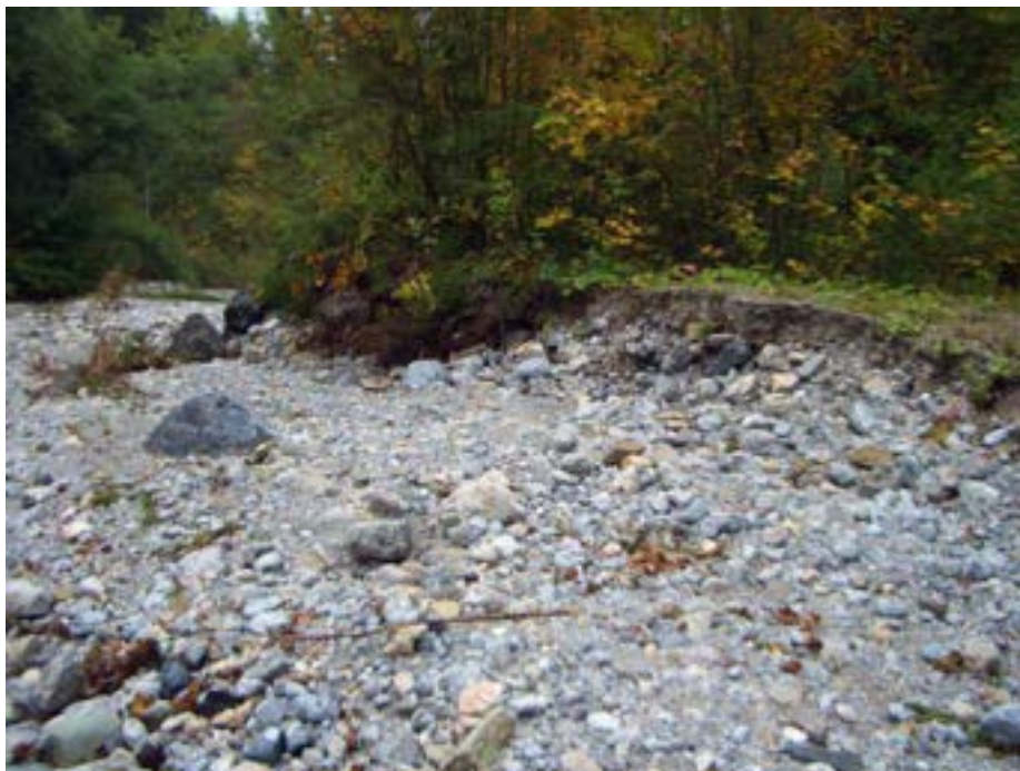
Vollständig abgetragene Steinschichtung (1 bis 1,5 m 3 /Stein; Kalkschuttbach), Unterspülung und Seitenerosion (SKL H) ©WLV
