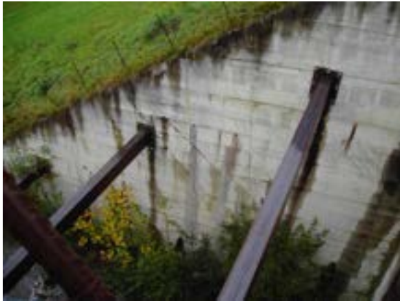
Schräge Abtreppungsriss (SKL U) ©Suda
