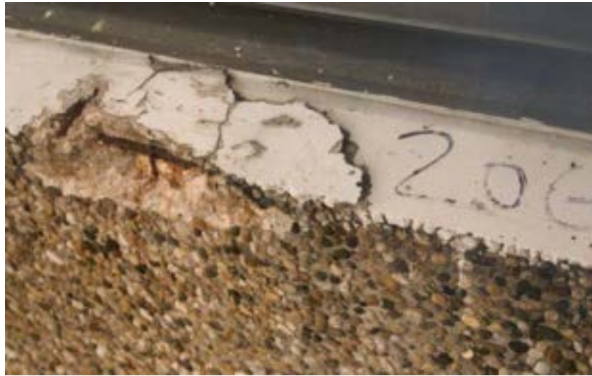
Abspaltung der Überdeckung durch korrodierende Bewehrung (SKL K)
