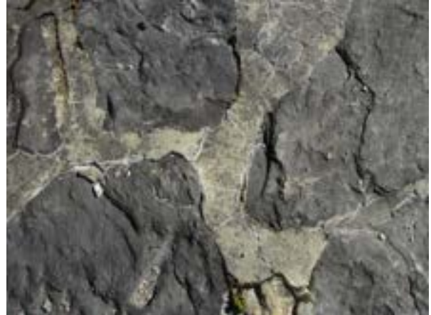
Risse im Fugenmörtel (SKL U)©Suda
