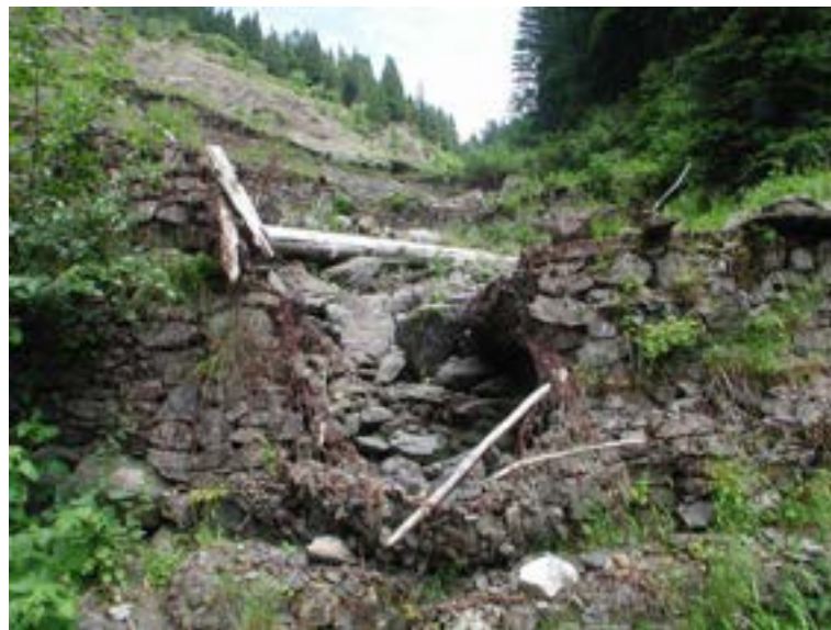
Abtrag der Füllung infolge einer Beschädigung des Drahtgeflechts (SKL H) ©Suda
