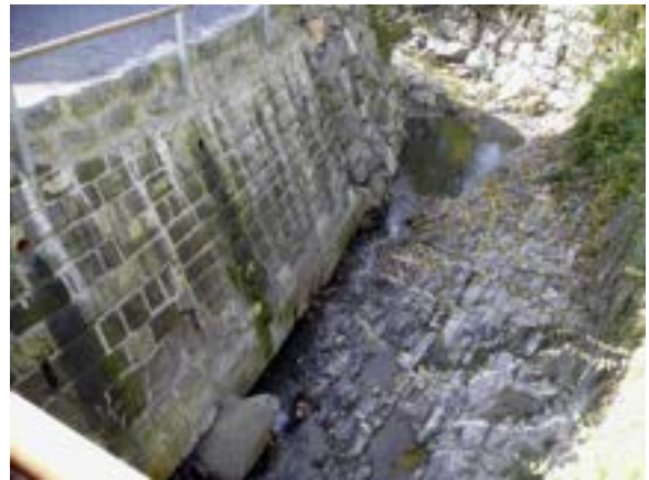
Deutlich sichtbare Unterkolkung der Mauer (SKL K) ©Suda
