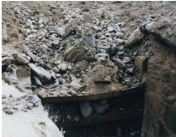
Verformter oberer Balken (SKL K) ©WLV
