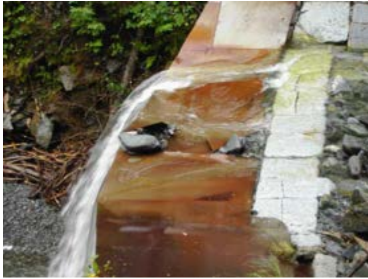
Verformtes Blech aufgrund von nachgebender Unterlage ©Suda
