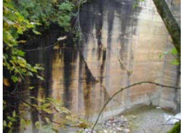
Schräge Abtreppungsriss (SKL U) ©Suda
