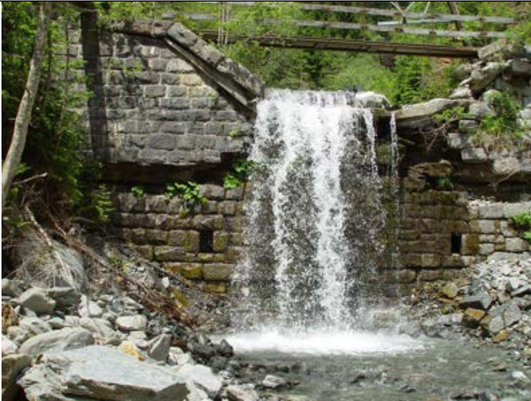
Risse im Bauwerk (SKL K) ©Suda
