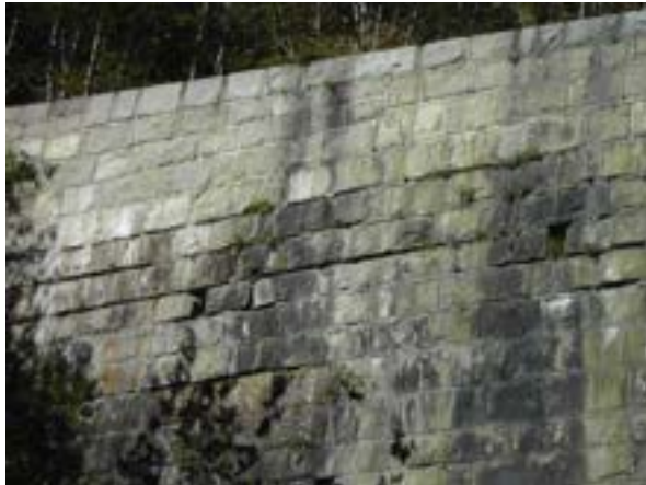
Durchfeuchtungen und Pflanzenbewuchs deuten auf eine Schädigung des Mauerkörpers durch Verwitterung hin, lokal fehlender Fugenmörtel (SKL U)©Suda
