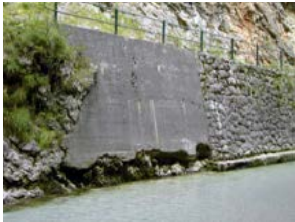
Freiliegende Unterkante einer Ufermauer (SKL K) ©Suda
