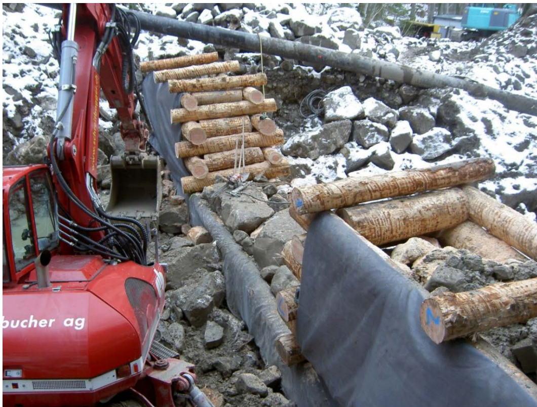
Abb. 2: Abflusssektion mit Blockausfuchung und wasserseitig eingebautes Geofiltergewebe zur Verhinderung von Auswaschungen (Bild: B. Ettlin).
