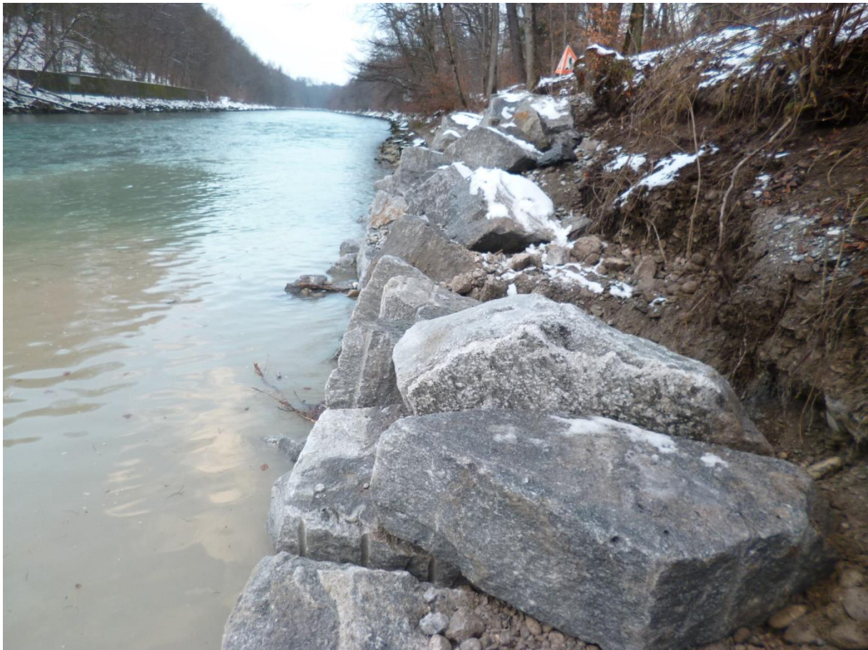
Schweizer Gneis in einem Längsverbau während der Erstellung (Foto 2013, Kästli Bau AG)
