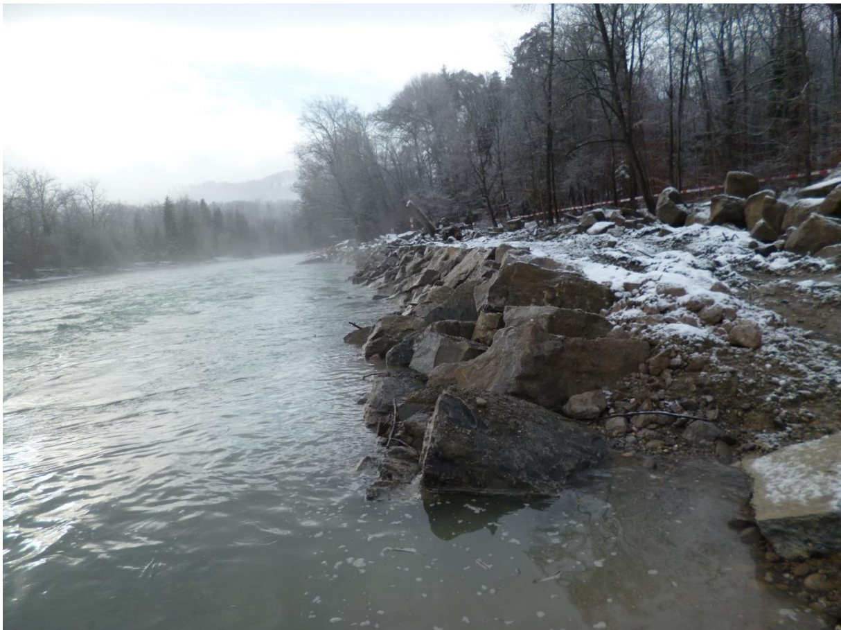
Schweizer Quarzsandstein in einem Längsverbau während der Erstellung (Foto von 2013, Kästli Bau AG)
