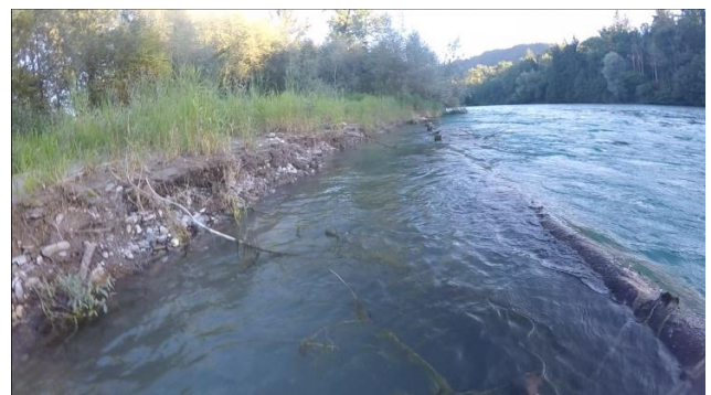
Beispiel eines überströmten und vollständig ausgekolkten Längsholzverbaus vor Sanierung (Foto 2016, Kästli Bau AG)
