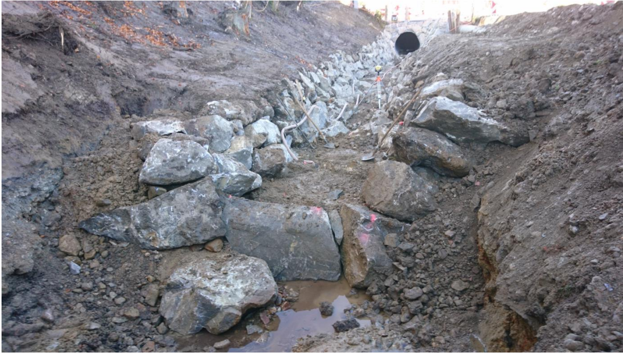
Eine Blocksteintreppe mit seitlichem Längsverbau während der Realisierung (Foto 2017, Kästli Bau AG)
