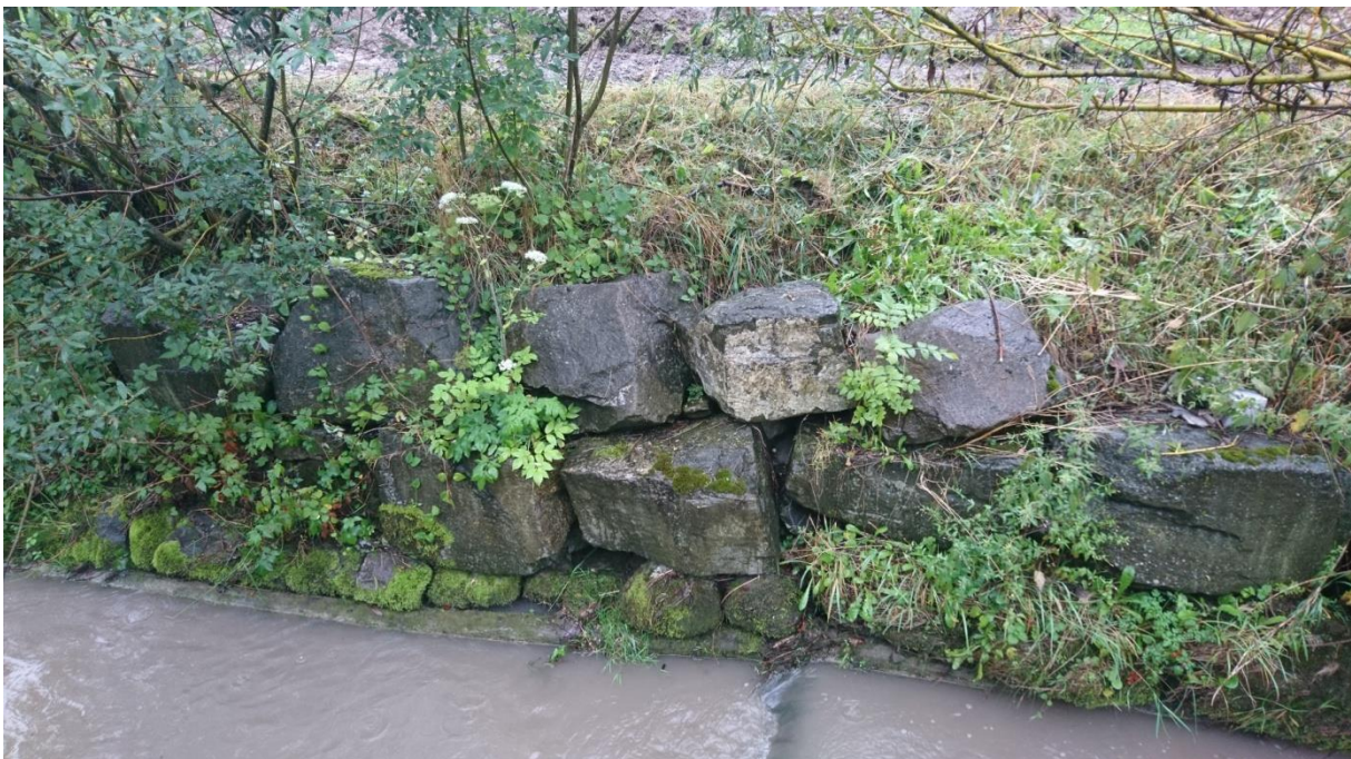
Ein kleiner, auf Längshölzern fundierter, stark ausgespülter Blocksatz (Foto 2017, Kästli Bau AG)
