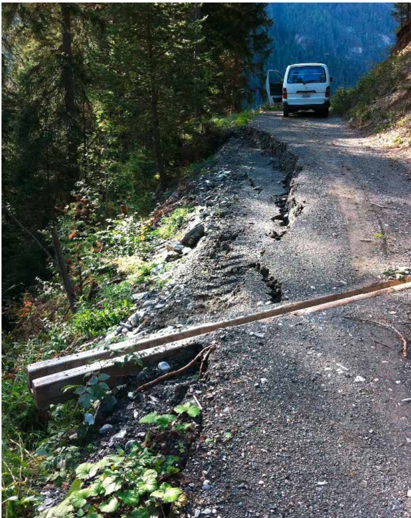
Abb. 9: Teilweise abgerutschter Strassenkörper. Aufgrund starker Durchnässung und evtl. mangelhaft verdichteter Schüttung am Böschungsfuss hat der Untergrund nachgegeben. Nach Beurteilung der Standsicherheit des abgerutschten Materials sind entweder Böschungsstabilisierungsmassnahmen oder lediglich Materialaufschüttung und Reprofilierung notwendig.
