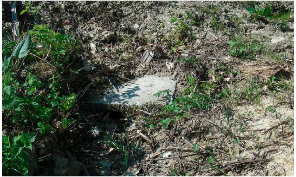
Abb. 14: Verfüllter Schacht mit Bewuchs und Erde. Im Ereignisfall ist die Funktion des Schachtes eingeschränkt. Eine Freilegung des Schachtes ist notwendig.
