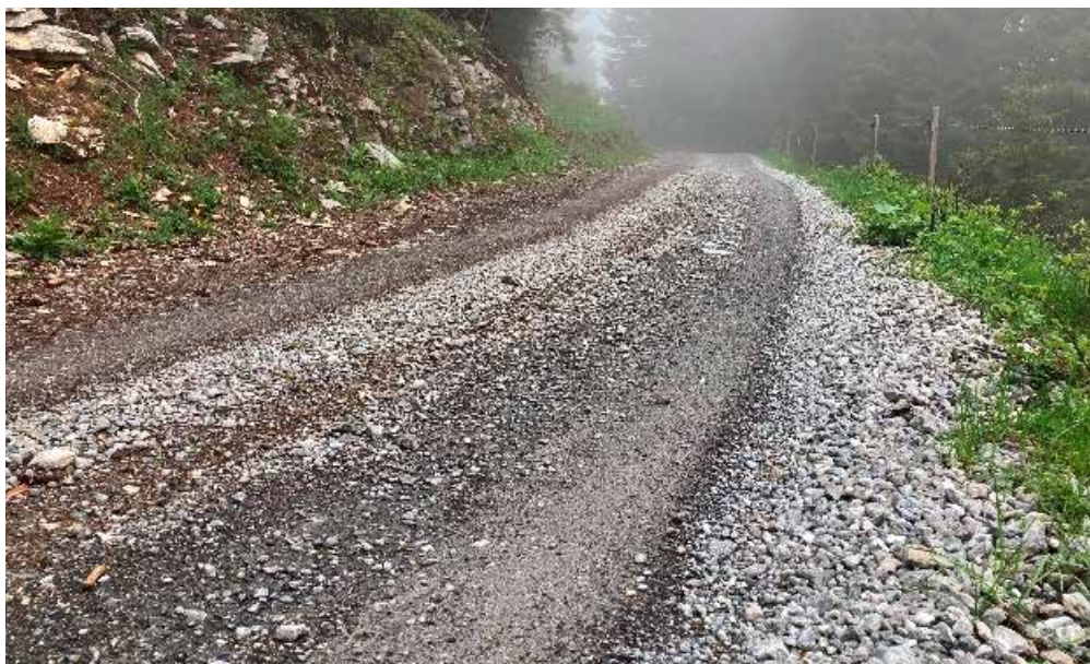
Abb. 3: Verlagerung und Entmischung (Feinanteilverlust) des Deckschichtmaterials aufgrund des Verkehrs. Es bilden sich Fahrspuren und Materialanhäufungen an den Fahrbahnrändern, welche die Oberflächenentwässerung der Strasse beeinträchtigen. Regelmässiges Rückholen und Neuverteilen des Deckschichtmaterials verhindert eine Entmischung und stellt die korrekte Ausformung des Strassenprofils sicher. Im vorliegenden Fall wurde der ideale Zeitpunkt für einen betrieblichen Fahrbahnunterhalt verpasst. Es sollten daher die obersten Zentimeter der Strasse mit einer Wegebaufräse bearbeitet werden (mischen, reprofiliere, verdichten). Ansonsten sind Folgeschäden (z.B. durch Erosion) vorprogrammiert.
