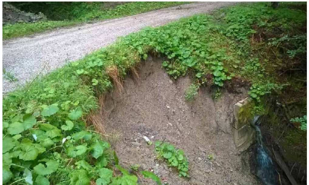
Abb. 8: Abgerutschte Böschung unterhalb der Strasse. Möglicherweise hat das Wasser aus dem Durchlass den Böschungsfuss erodiert, worauf dieser abgerutscht ist. Es ist sicherzustellen, dass der Böschungsfuss nicht erodiert werden kann. Zudem muss die Böschung stabilisiert werden.
