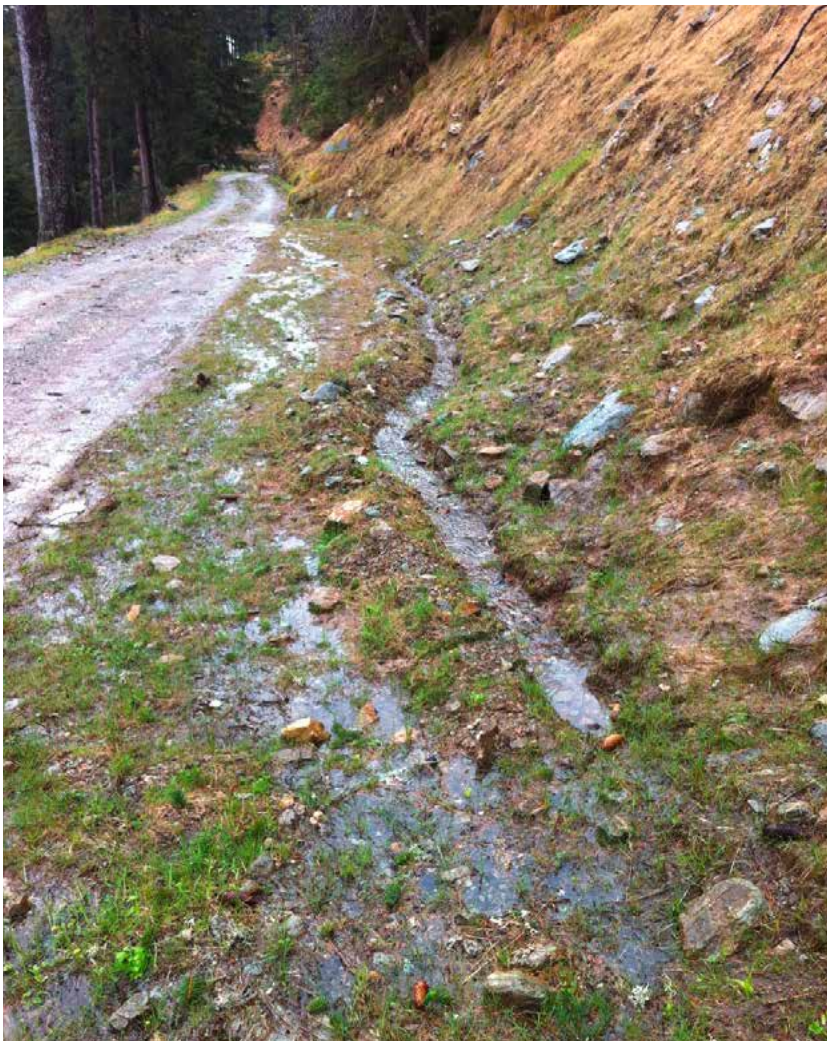
Abb. 15: Ungenügende bergseitige Längsentwässerung, wobei bereits Erosionsprozesse im Bereich des Fahrbahnrandes und Banketts sichtbar sind. Zudem ist das Quergefälle der Strasse inkl. Bankett ungenügend. Eine Reprofilierung der Strasse sowie die Erstellung eines bergseitigen Entwässerungsgrabens inkl. Ableitung bzw. Durchleitung des anfallenden Wassers ist notwendig.
