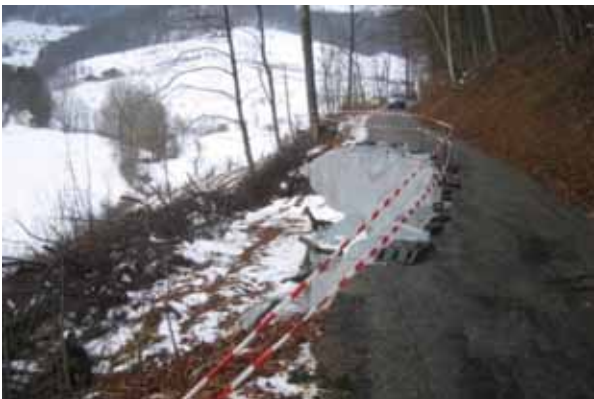
Abrutschung eines Strassenstücks, Eptingen
