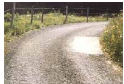
Altersbedingte Ausmagerung des Deckbelages.
