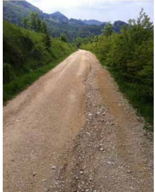
Wasser fliesst in der Fahrspur weil es seitlich nicht abfliessen kann. Es wird Material aus der Deckschicht ausgewaschen, Waldenburg.
