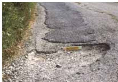
Schottertränkung löst sich auf. Es bilden sich Schlaglöcher.
