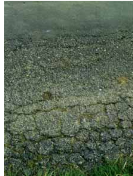
Netzrisse bzw. Elefantenhaut als Anzeichen für zerstörte Foundationsschicht, Bretzwil
