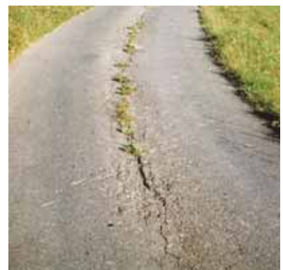
Mittelriss in einem Asphaltweg
