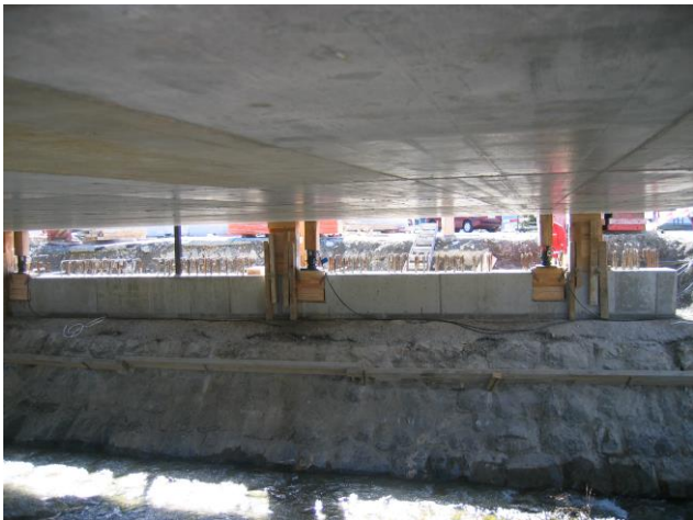
Die in Nischen montierten hydraulischen Pressen.
