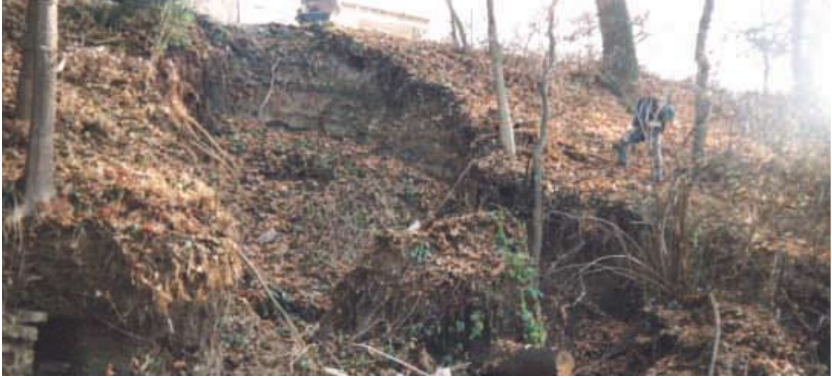
Uferabbruch an der Echaz (1997)
