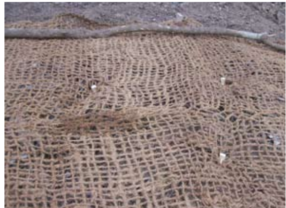
mit Böschungsnägeln aus Holz befestigte Erosionsschutzmatten (Oktober 2010)
