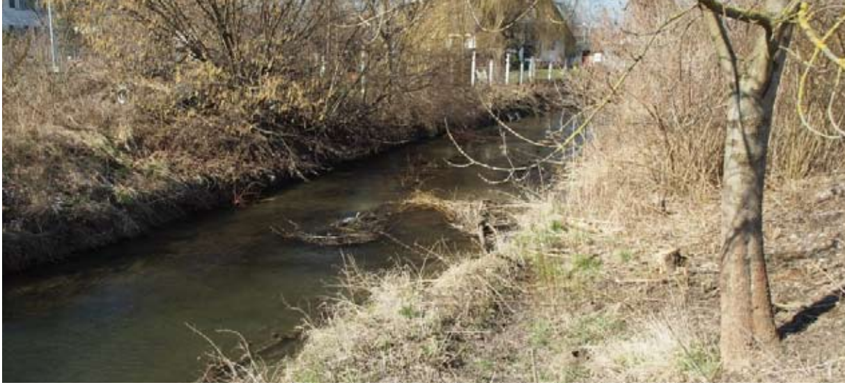
Unterer Abschnitt, Ausgangszustand, rechtes Ufer aufgelandet, linkes Ufer erodiert
