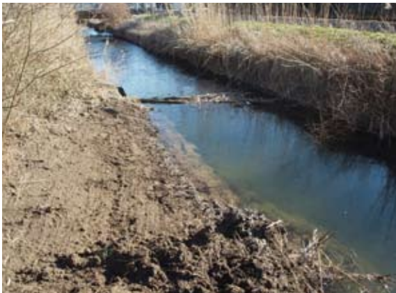
Oberer Abschnitt, zunehmend erodiertes Ufer zur Bahnlinie hin
