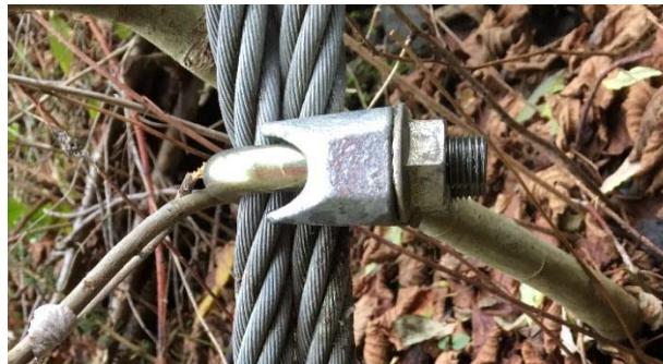
Abbildung 5: Seilklemmung bei einer DSK Grösse 22 welche nach EN 13411-5 geschmiert mit 107 Nm angezogen wurde.
