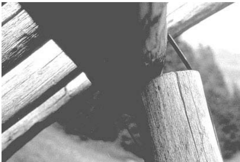
Abb. 62 Die Detailaufnahme zeigt ein fehlendes Pfettenlager. Die aufliegende Pfette findet keinen Halt und wird abgepresst (Butzenweid/Fadental, Spiringen, UR).
