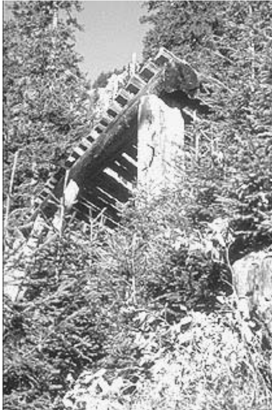
Abb. 66 Bei dieser Verbauung wurde ein senkrechter Stock als Stütze und ein Stamm als Pfette verwendet. Zudem weisen die Rostbalken eine deutlich ungenügende Vorkragung auf (Güpfi, Lungern, OW).
