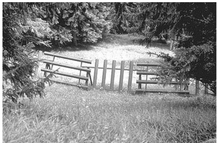
Abb. 64 Dieser Permanentverbau aus Stahl steht in gutwüchsigem Gebiet auf 1600 m ü. M.. Ein temporärer Stützverbau und Gleitschnee-Schutz mit Aufforstung würde an dieser Stelle ausreichen (Brüchwald, Davos, GR).
