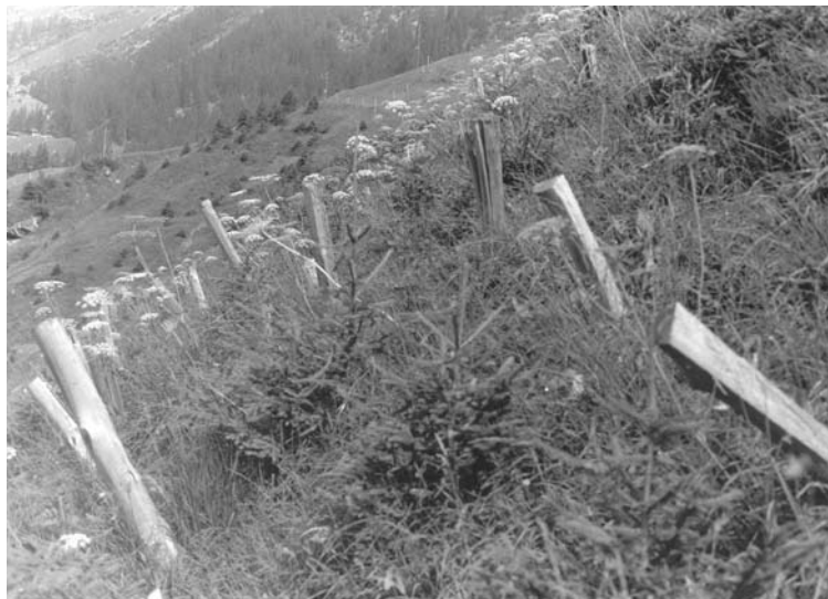
Abb. 81 Auch hier ragen die Pfähle zu weit aus dem Untergrund, nur 50 cm stecken im Boden, 100 cm ragen hinaus. Zudem sind die Abstände nicht korrekt. Diese Pfählung ist unwirksam, weil im Schlagverhältnis 1:2 eingebaut, was bald zum Totalausfall der Anlage führen wird (Lehmatten/Heger, UR).
