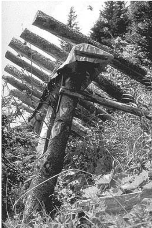
Abb. 63 In dieser Verbauung wurde unbehandeltes Nadelholz mit Rinde verlegt. Nadelhölzer wie Föhre oder Tanne müssen, sollen sie für den Stützverbau verwendet werden, industriell imprägniert werden (Schwifäri/Leidplangge, GL).
