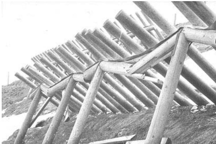
Abb. 58 Zu klein dimensionierte Pfetten bei diesem Stützverbau im Wächtenbereich ( H_s \geq 4,5 m) brechen unter der aufliegenden Last zusammen (Mayens de Conthey, VS).
