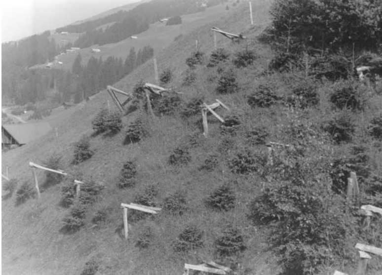
Abb. 85 Anlage mit zusammengebrochenen Dreibeinböcken. Die Stützen sind angespitzt und versinken so langsam im Boden, zudem sind die Träger unterdimensioniert (Lehmatten/Heger, UR).
