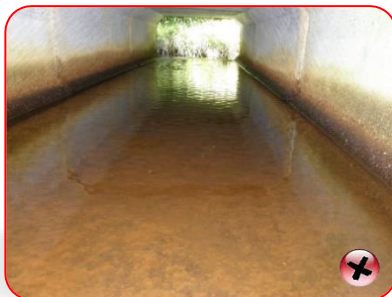
Lame d'eau insuffisante
