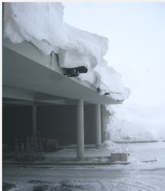
Cliché 19. Formation de corniches au niveau du bâtiment des douanes de la Porta, liée notamment au raccordement du bâtiment au terrain naturel (Socotram)
