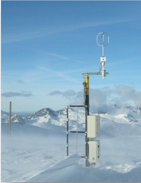
Cliché 9. Flowcapt constitué de 6 segments installé au Col du Lac Blanc (F. Naaim-Bouvet / Irstea)
