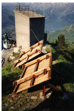
Cliché 101. Crête du couloir du Theil, toits-buses à tablier bois, portés par 6 poteaux acier ancrés dans un massif béton (ONF_RTM 64-65).
