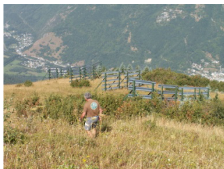
Cliché 90. Oz en Oisans : Barrières à neige métalliques (ONF_DT RTM, août 2012)
