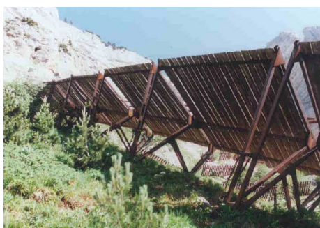
Cliché 85. Saint-Hilaire du Touvet_ 38, toits-buses ancrés et tablier bois faiblement ajouré.
