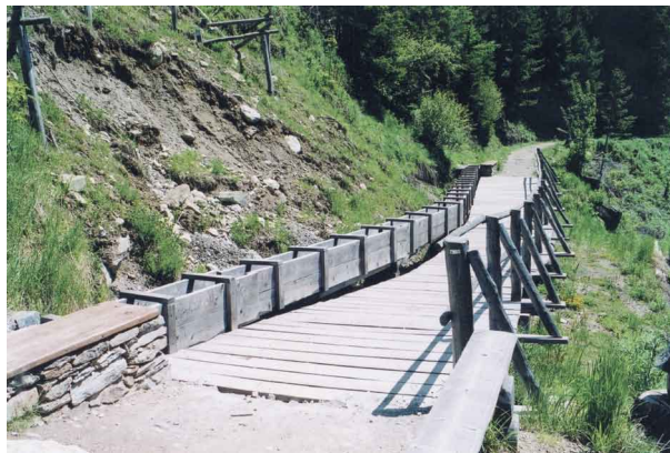
Figure 73. Le chemin et le canal sont maintenus en service malgré le glissement (Chemin du Trient, Valais, Suisse).
