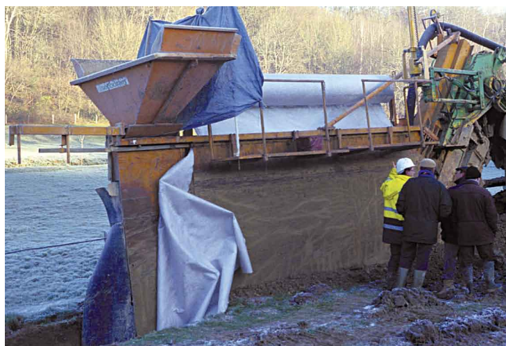
Figure 39. Le Bec Thomas - Sur la tranchée : le filtre géotextile qui se place sur la paroi amont de la tranchée, le drain collecteur qui se place au fond, la trémie qui reçoit le gravillon drainant.
