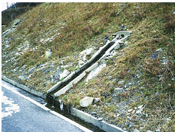
Figure 48. Exemple de collecte des eaux d'exhaure bien aménagée et entretenue
