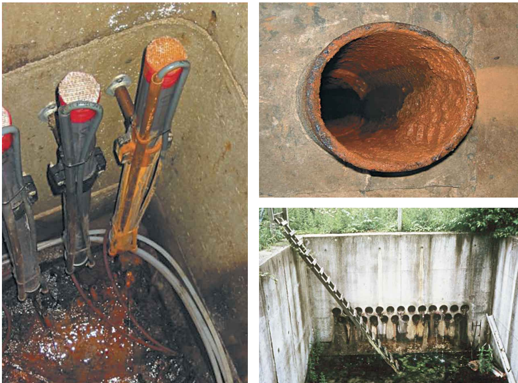
Figure 33. (a) Dépôts d'oxyde dans un tuyau (photo AquaBiotics), (b) Développement de bactérie dans un regard (photo J.-C. Gress, Hydro-Géotechnique), (c) Exutoire de drains au Petit Caporal (photo T. Dubreucq, LCPC)
