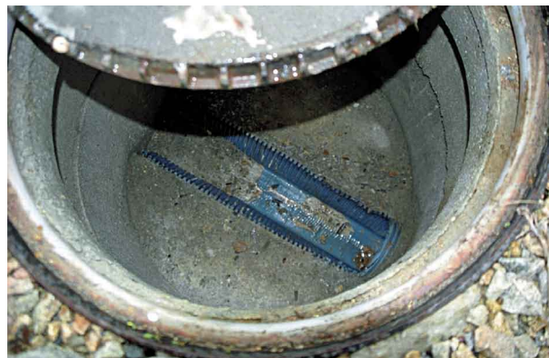
Figure 31. Regard visible standard – photo d'un regard visible : on remarque le dépôt de sable dans le drain
