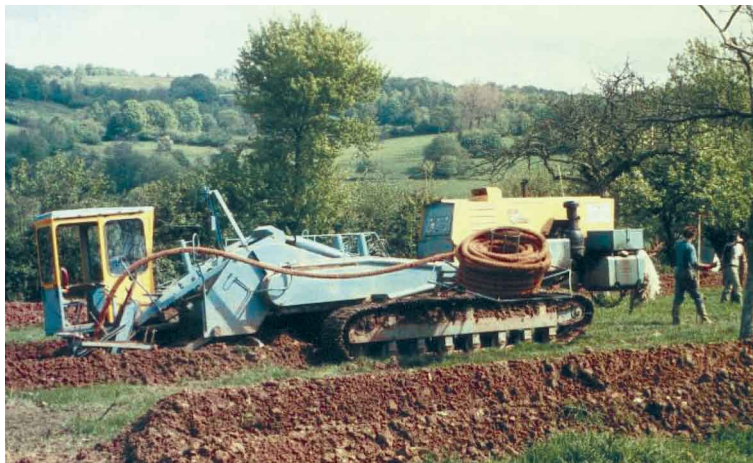
Figure 38. Drainage par tranchées (A 13 Dozulé) - Mise en place des drains par trancheuse de type agricole à une profondeur de 1,50 à 2,00 m. Au passage des haies, le drain est remplacé par un tube sans perforation.
