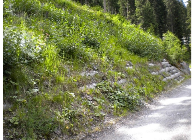
Illustration 29 recouvrir les caissons et suivre le fruit naturel du terrain assure la longévité de l'ouvrage. Le caisson peut absorber certains mouvements de terrain.
