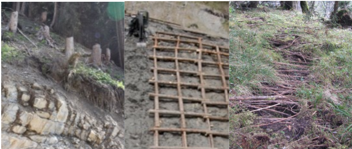
Illustration 48 Situations montrant les différents mécanismes: renforcement basal (à gauche), rigidité de la couche supérieure tel une armature technique de sol au milieu, renforcement latéral à droite.
