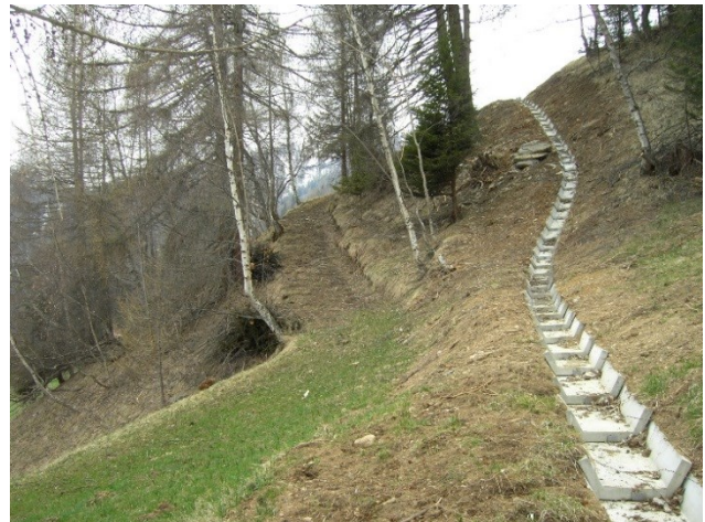
Illustration 14 Cunettes en béton polymère (bap Ing.).
