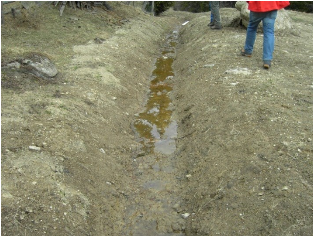
Illustration 22 fossé étanchéifié avec une natte de bentonite pour une dérivation contrôlée des eaux (bap Ing.)
