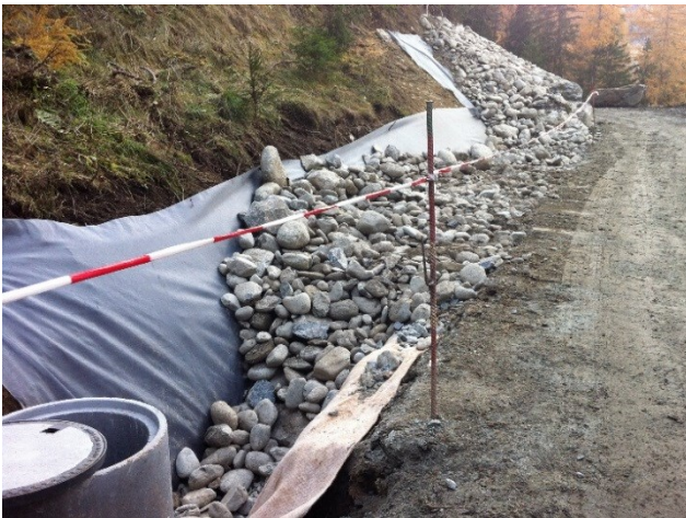
Illustration 18 Fossé drainant avec géotextile (filtrer/drainier) du côté de l'amont et géotextile étanche du côté de la route (Bentonit) am Grund et regard de contrôle (AWN GR).
