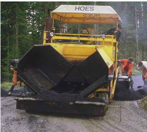
Abbildung 31 Asphaltbeton AC T 16N beim Einbau auf UG 0/45 respektive UG 0/16 Planie (AWN SZ).
