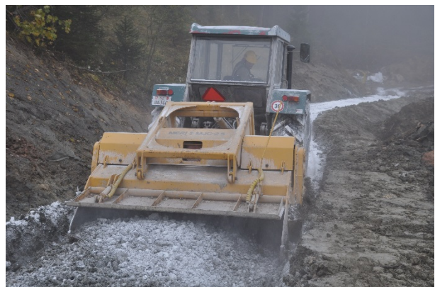
Abbildung 38 Durchmischung mittels Fräse bei einer Kalkstabilisierung, welche die Wasseraufnahme senken und die Tragfähigkeit erhöht (AWN SZ).
