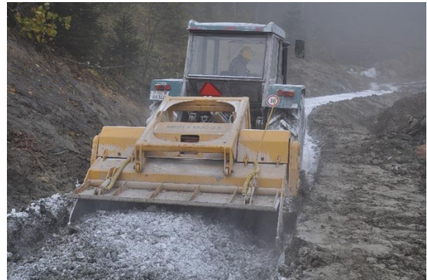
Illustration 36 Mélange de la chaux et des terrains à la fraise, réduction de l'eau et augmentation de la portance (AWN SZ).
