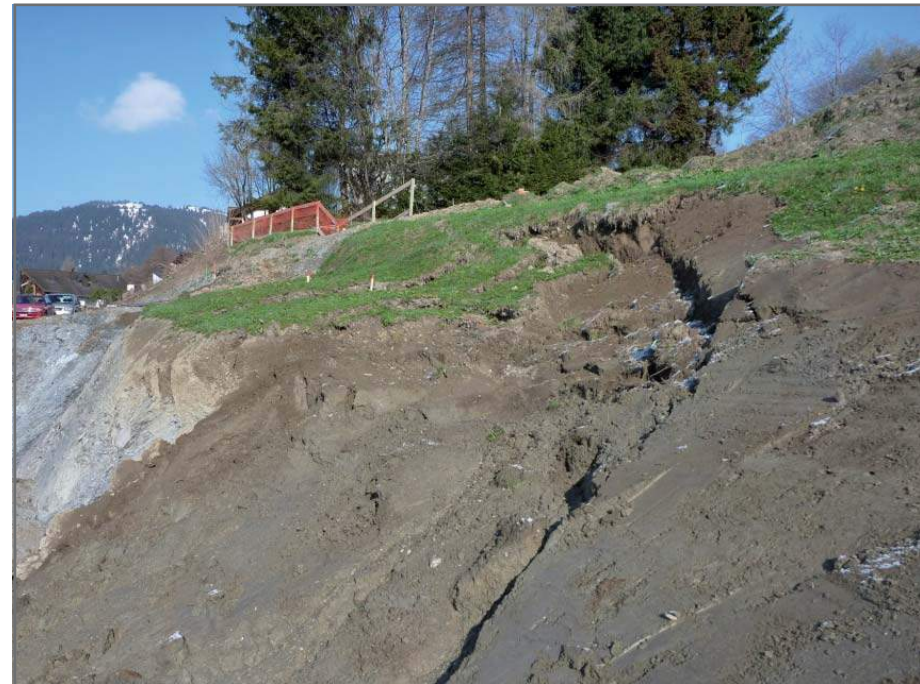
Rupture de talus dans une fouille importante (2010)
