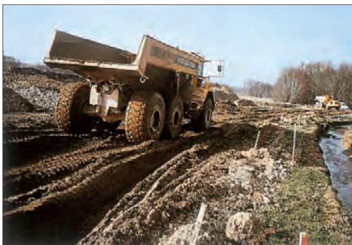
Cas typique d'une PST n°0 impropre à la mise en oeuvre d'une couche de forme
