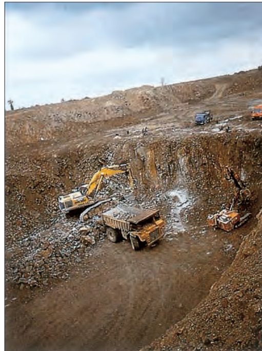
Pour caractériser un déblai rocheux, il faut au préalable être en mesure de prévoir à partir de la roche en place le comportement du matériau après abattage.
