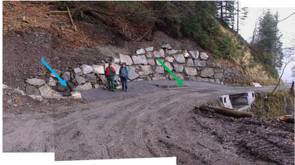
Entrée du passage busé et grille de délestage en cas de surcharge
