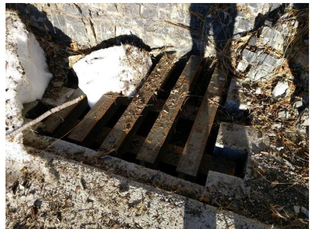
Abb. 7: Stahlrost aus H-Profilen (Bild: Von Moos).
