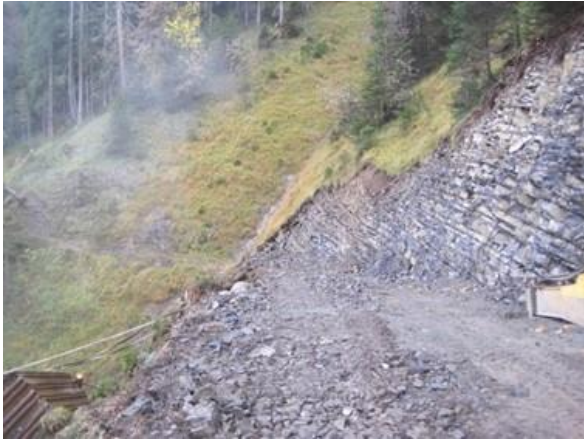
Illustration 8 : Tracé brut de la nouvelle route forestière à travers le ravin. A gauche, les palissades en acier pour retenir les matériaux d'excavation.
