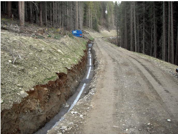
Abbildung 3: Rohbau bei Kilometer 0.3 mit bergseitiger Sickerleitungen zur Fassung von Hangwasser (Foto: H. Richener)
