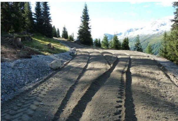
Abbildung 17: Verschleisssschicht vor Planie mit Grader und dem Verdichten beim Waldweg im Herbst 2011 (Foto: H. Richener)
