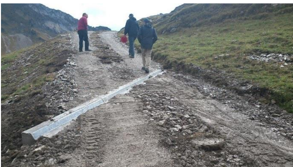
Abbildung 8: Fertiggestellter Querabschlag; Detail: Der längere Typ B ermöglicht einen geringeren Ableitwinkel für das Wasser
