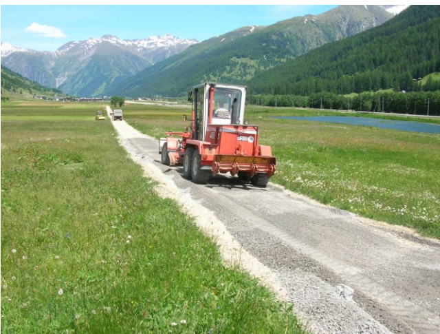
Abbildung 10 Der Einbau einer kalk-wassergebundenen Verschleisschicht mit Grader ist schwieriger als mit dem Einbaufertiger.
