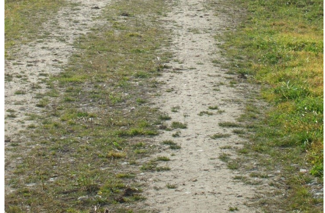
Abbildung 13 Oberbau mit Schotterrasen von nahem betrachtet.
