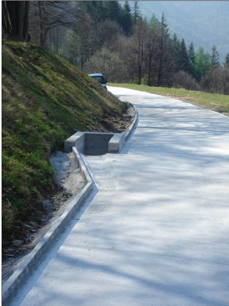
Foto 7: Particolare del sistema d'evacuazione delle acque meteoriche. Con la pendenza a monte di tutta la strada, l'acqua piovana viene trasportata in apposite camerette gettate sul posto e tramite tombini essa viene rilasciata ai piedi della scarpata di valle, in un punto sicuro, dove non può causare smottamenti o erosione.
