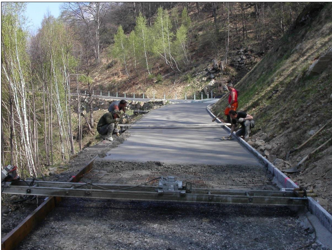
Foto 6: Dopo il costipamento del calcestruzzo, la superficie della strada va interamente talocciata e irruvidita mediante scopatura. La staggia vibrante è stata modificata per poter usare il cordolo a monte come cassero.
