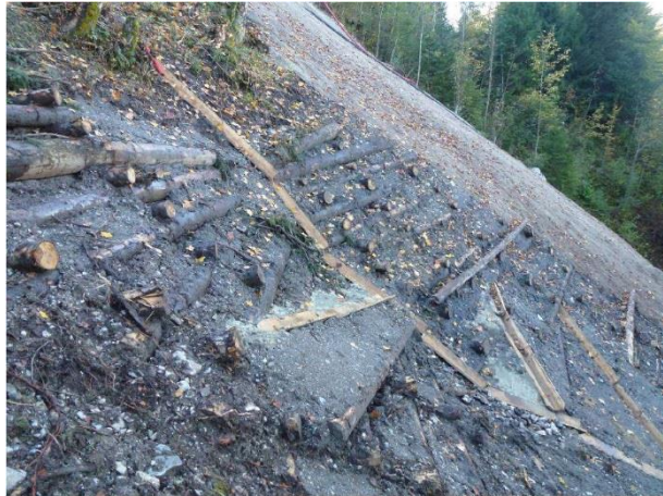
Holzkasten und Holzkännel zur Entwässerung (2012)
