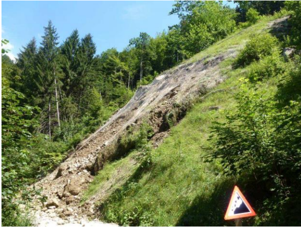
Abbildung 1: Anrisse und Aufstauchungen im Rutschhang an der Wandfluebergstrasse (13.07.2012)
