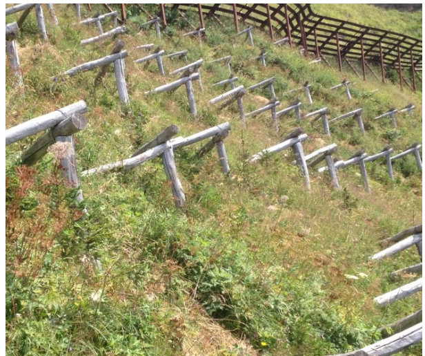
Abbildung 8 Dreibeinböcke innerhalb der Schneebrücken-Verbauung
