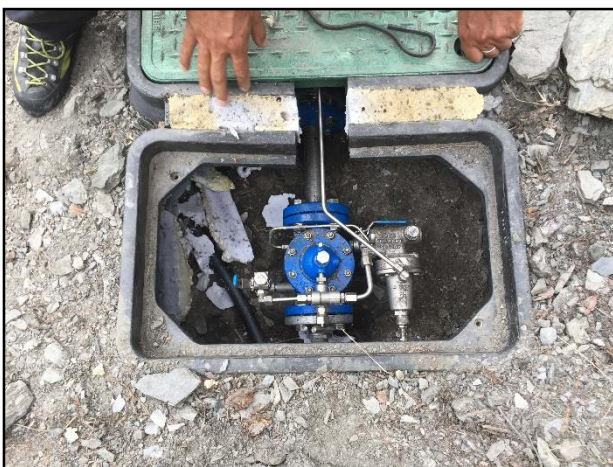
Figure 12 : vanne d'alimentation avec sécurité
