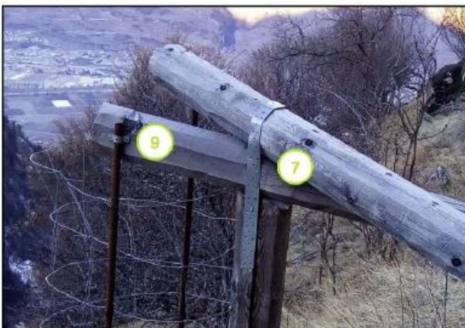
Figure 9 : fixation des barres à mine au sommet des trépieds
