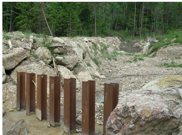
Abbildung 6: Detail Geschieberechen beim oberen Schutzdamm mit Blick zu dessen bergwärtigem Ende.
