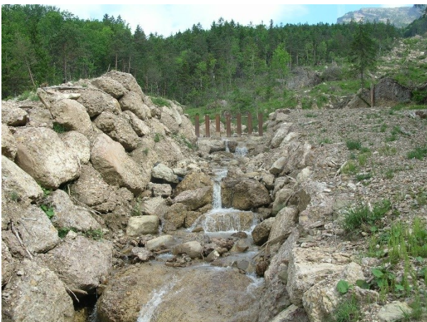
Abbildung 5: Geschieberechen beim oberen Schutzdamm zum Schutz der Strasse und deren Durchlass vor Kleinereignissen.
