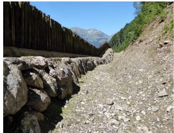
Abbildung 11 Blocksteinmauer und auf der vorgelagerten Betonmauer aufgesetzte Palisade.
