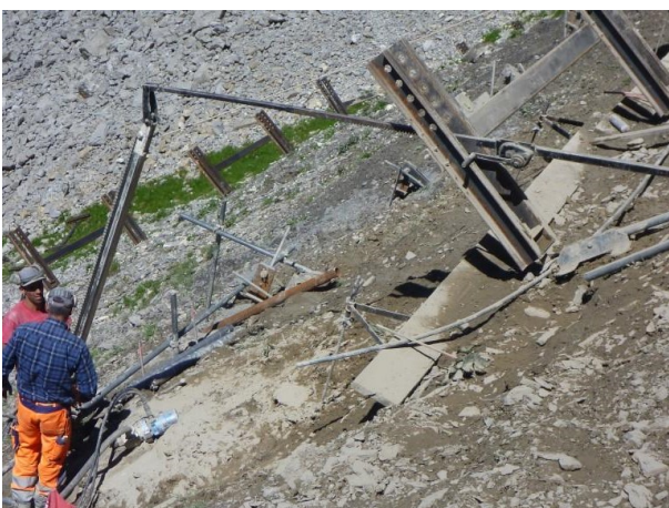
Abbildung 5: Einsatz der Bohrlehre zur Ermittlung der Position der Bohrlöcher für die Stützenanker (AFJ 2014)
