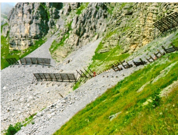
Abbildung 11: Montage der Stahlschneebrücken in Etappen, Blick auf die obere Werkreihe (Kalbermatter GmbH 2014)
