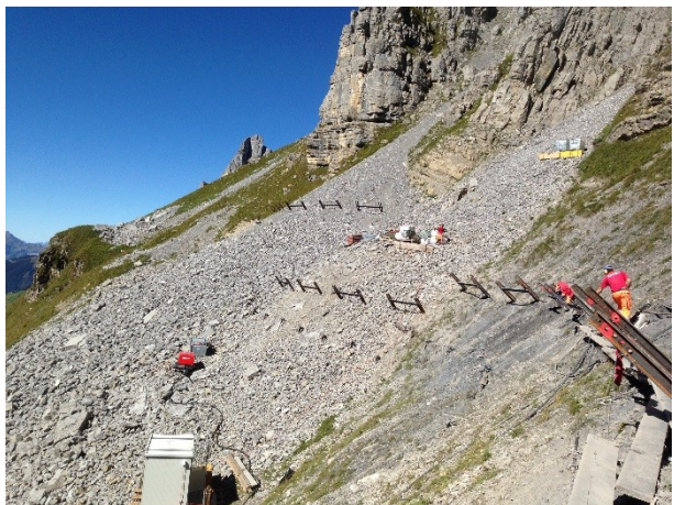
Abbildung 10: Die oberen Werkreihen sind für die Montage der Stützen und Träger vorbereitet (Epp 2013)
