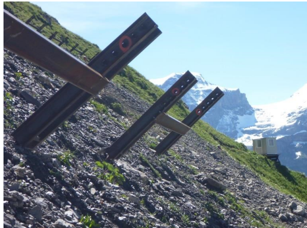
Abbildung 4: Installierte Ankerzangen, welche durch Bolzen mit den Trägern der Stahlschneebrücke verbunden werden (AFJ 2013)
