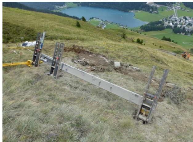
Abb. 3 (links unten): Fertig errichteter Unterbau. Abb. 4 (rechts unten): Fertig errichteter Unterbau eines Randwerks mit «Doppelbock-Konstruktion».
