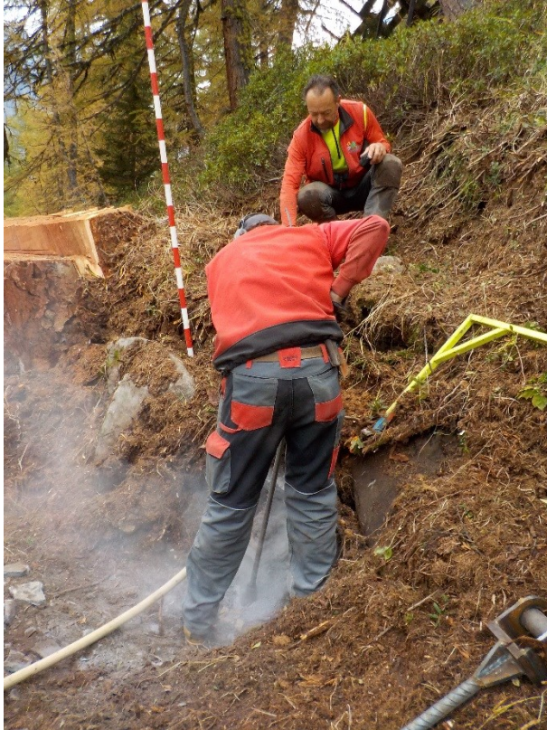
Abbildung 13: Mit dem Handbohrgerät wird das Bohrloch für den Erdnagel vorgebohrt (Torrent, Leukerbad 2014)
