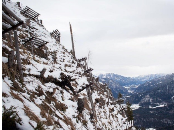
Abbildung 2: Die steile Hangneigung bei Runca (-42°) erfordert lange Stützen; aufgelöst, gestaffelte Anordnung (März 2014)
