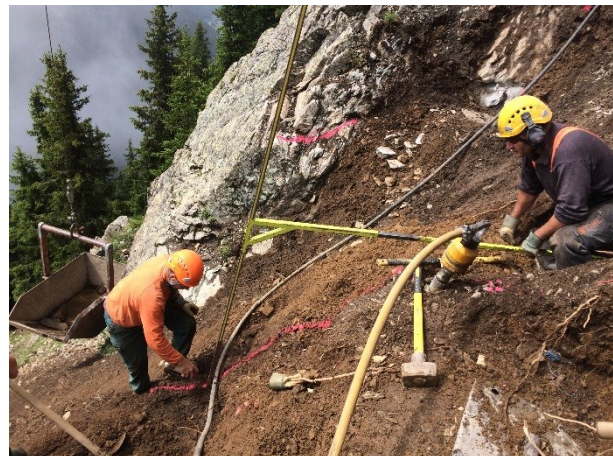
Abbildung 12: Mithilfe der Baulehre werden die genauen Positionen der Bodenplatten festgelegt (Seehorn, Davos 2014)
