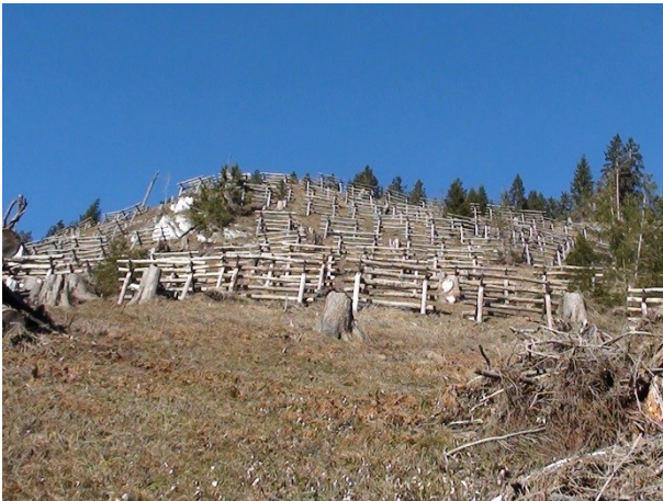
Abbildung 3: Bergwärtiger Blick in die apere Verbauungsfläche Runca; jeweilige Werkabstände von 1 m (Dezember 2013)
