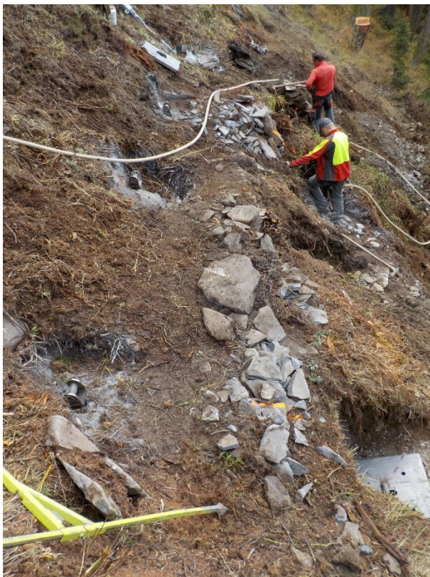
Abbildung 15: Fertiggestellte Erdnägeln (für die Brückenträger) und Stützenplatten (für die Stützen) (Torrent, Leukerbad 2014)
