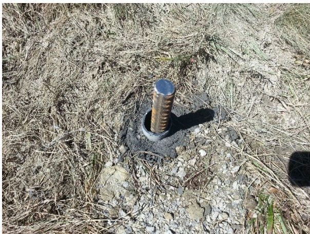
Abbildung 15: Fertig versetzter Zuganker, welcher nach Austrocknen des Mörtels für den Ausziehversuch bereit ist
