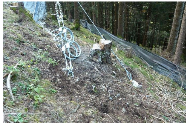
Abb. 12: Bremsseile (links) und Abspannseile (rechts) an den Ankerlaschen der Spiralseilanker (Foto: H. Richener).
