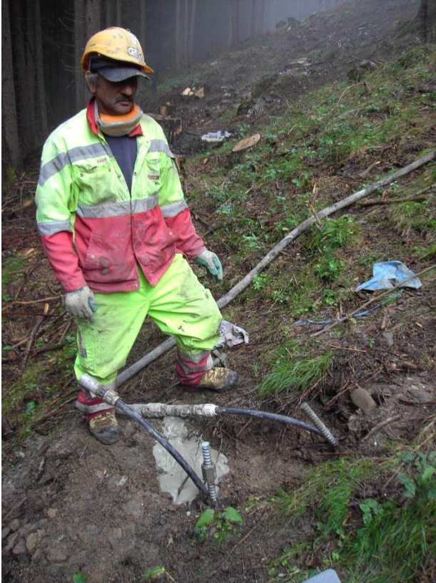
Abb. 10: Injektion des Ankermörtels durch miteingeführte Injektionsschläuche. Diese werden nach der Injektion gekappt und im Fundament belassen (Foto: H. Richener).
