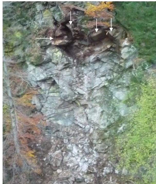
Abbildung 6 Die Ausbruchsstelle mit weiteren losen Partien.
