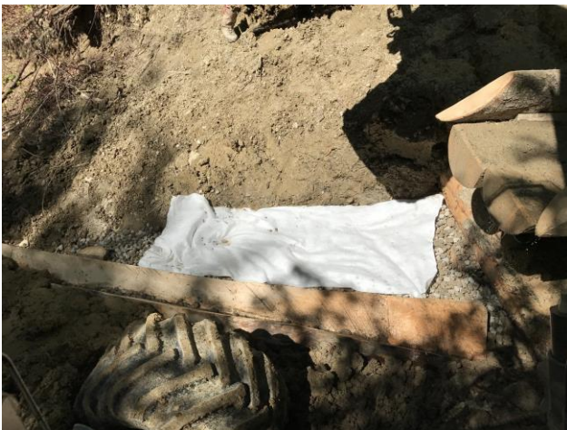
Abb. 7: Im Abfluss- und Einflussbereich des Entwässerungskän- nels wurde Sickerkies eingebracht, das als präferenzierter Fließweg den Boden vor zu hoher Wassersättigung schützen soll.
