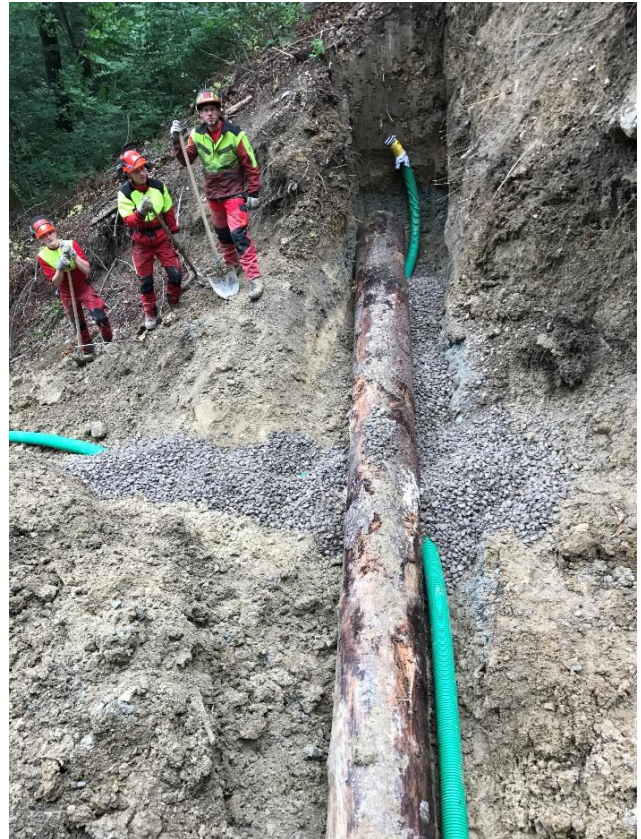
Abb. 2: Erste Lage des Holzkastens: Unter dem talseitigen Längsholz wurde die erste (von zwei) Sickerleitung angebracht. Es besteht sowohl eine seitliche als auch eine Sohl-Einbindung.
