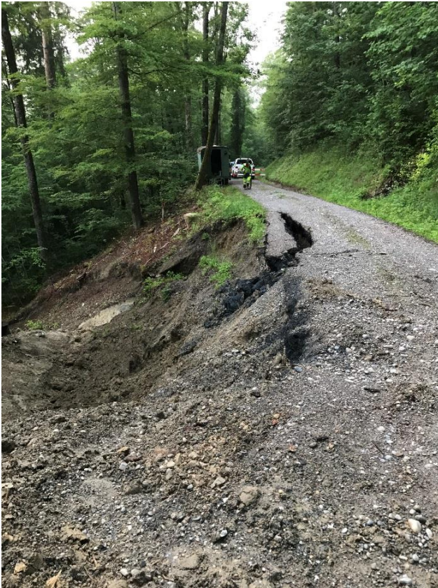
Abb. 1: Ausgangslage vor dem Bau: Das Strassenbankett und Teile des Strassenkörpers sind weggerutscht.
