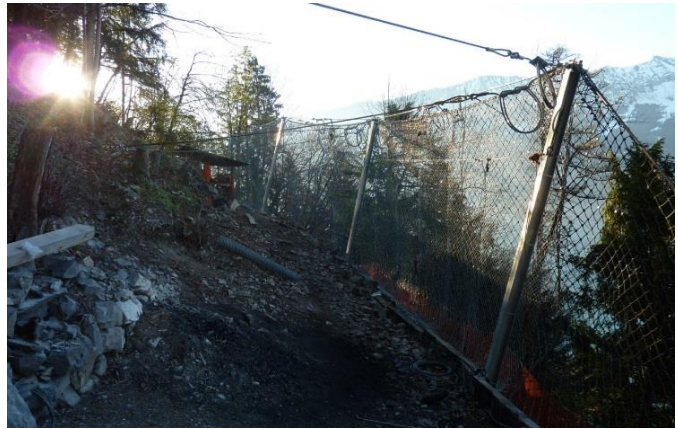
Abb. 1: Installiertes Steinschlagnetz ISOSTOP 2000 kJ, Beatushöhlen (Foto: IMPULS AG, Thun)
