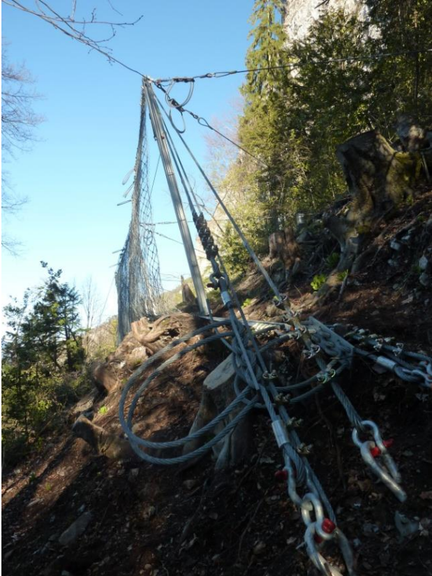
Abb. 9: Bremsen- und Ankerköpfe des Netzes von der Ostseite der Verbauung, Foto vom 2.4.2014
