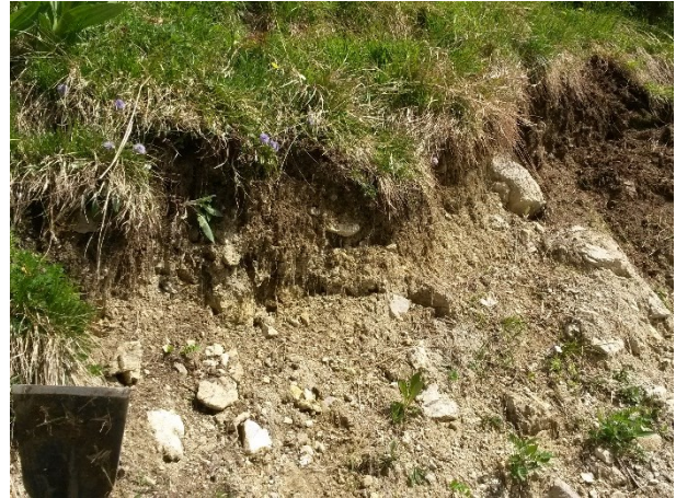
Abbildung 2: Detail: Anrisskante an der Böschung (Tropfnase), der sich zunehmend ausdehnenden Erosionsfläche
