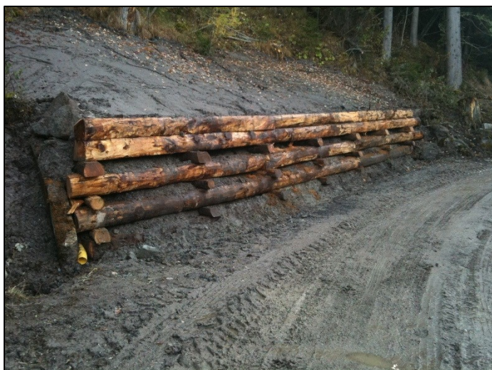
Photo 10 : Caisson de soutènement en bordure de route forestière (5) avec sortie de drainage vers le torrent à côté
