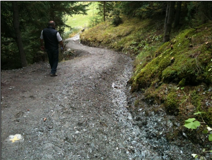
Photo 13 : Chenal à ciel ouvert étanchéifié avec une natte de bentonite (2)
