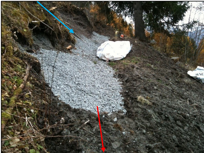
Photo 6 : Captage d'entrée du collecteur avec Misapor. La flèche bleue indique l'arrivée des drainages en bois et la flèche rouge le départ du collecteur (cf photo 4). (6)
