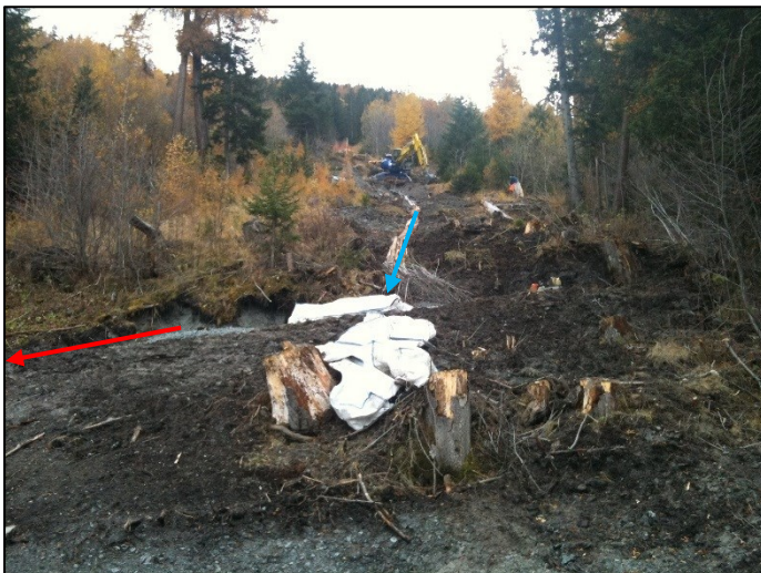
Photo 7 : Arrivée des drainages en bois dans le captage d'entrée du collecteur (6)
