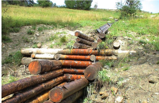
Holzkästen, Sicht vom zweiten Holzkasten Richtung V-Kanäle
