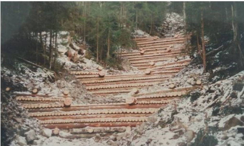
Photo 9 : rénovation de la partie supérieure (1,5 m de hauteur et ailes sur base existante) du seuil 36 et suivants.
