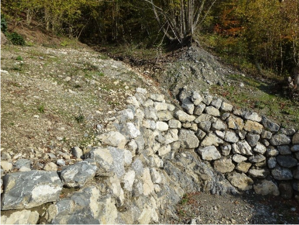
Abbildung 7: Einlaufbauwerk beim Geschiebesammler 1
