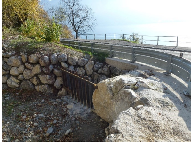
Abbildung 8: Geschieberechen beim Geschiebesammler 1 mit Einlaufbauwerk vor dem Strassendurchlass; zur Strasse hin musste eine Leitplanke montiert werden
