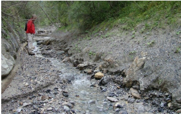
Abbildung 1: Flächige Sohleneintiefung innerhalb des Ablenkanals unterhalb einer Sohlschwelle
