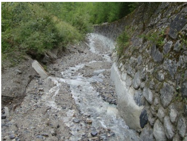
Abbildung 3: Spuren von Murgangereignissen im Ablenkanal und an der talseitigen Ablenkmauer
