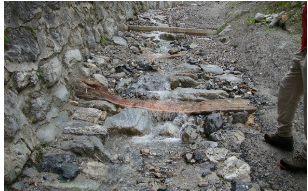
Abbildung 2: Abrasionsspuren an den Sohlswellen, darunter liegend die aufgerissene Sohlenpflasterung
