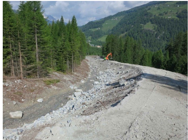
Rähne am Böschungsfuss als Erosionsschutz gegen Murgänge
