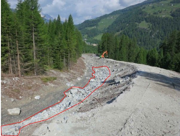
Abbildung 7: Blick in Fließrichtung auf das fertiggestellte Gerinne mit Erosionsschutz (Rähne mit Buhnen; rot umrahmt)
