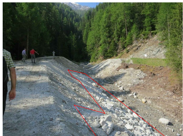
Abbildung 6: Entlang der unteren Böschungskante des Schüttdammes wurde die Rähne erstellt (rot umrahmt)
