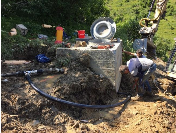
Abbildung 14: Betonierte, bereits vorhandene Brunnenstube, wo das Wasser für die Treibleitung gewonnen wurde.
