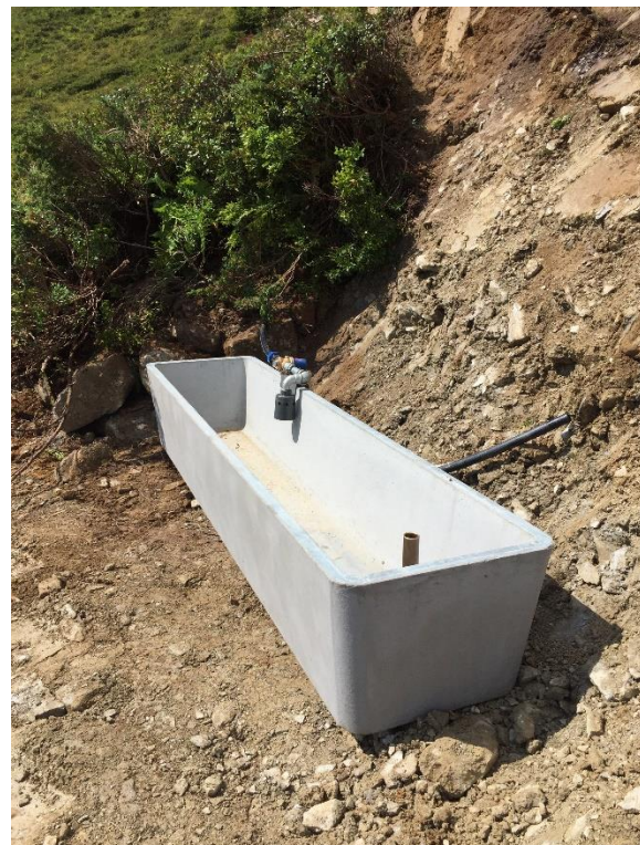
Abbildung 17: Fertig installierter Brunnenrog mit Schwimmer vor der ersten Inbetriebnahme.
