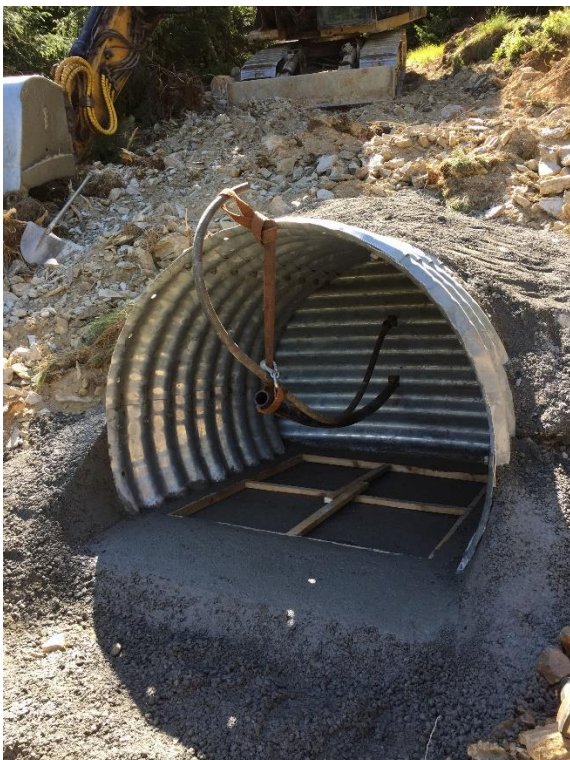
Abbildung 12: Fertig gebauter Unterstand für den Widder mit der vorbereiteten Druck- bzw. Steigleitung.
