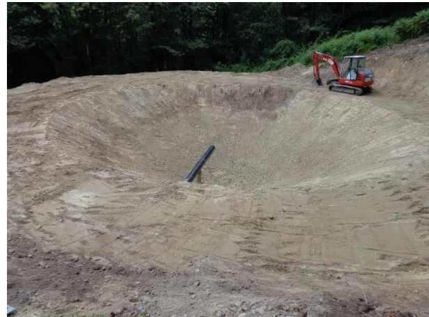
Verlegen des Zulaufes und Ausformen der Teichböschung Interramento tubi di riempimento e finitura delle pendenze Pose de l'arrivée d'eau et aménagement du talus de l'étang
