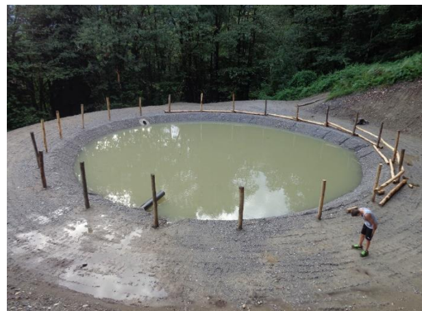
Füllen des Löschwasserteiches und Bau des Zaunes Riempimento vasca e posa della recinzione in castagno Mis en eau de l'étang et clôture
