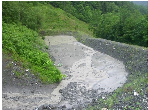
Abbildung 7 Durch das Unwetter vom Juni 2007 wurde der neu erstellte Geschiebeablagerrungsdamm vollständig hinterfüllt und es kam zum Überlastfall, ohne dass am Bauwerk ein Schaden entstand. [2]
