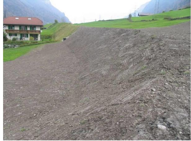
Abbildung 11 Der neu erstellte Damm schliesst die Lücke zwischen dem bestehenden Lawinenschutzdamm Matt und dem Murgangdamm der Schutzdammliegenschaft (2007). [5]
