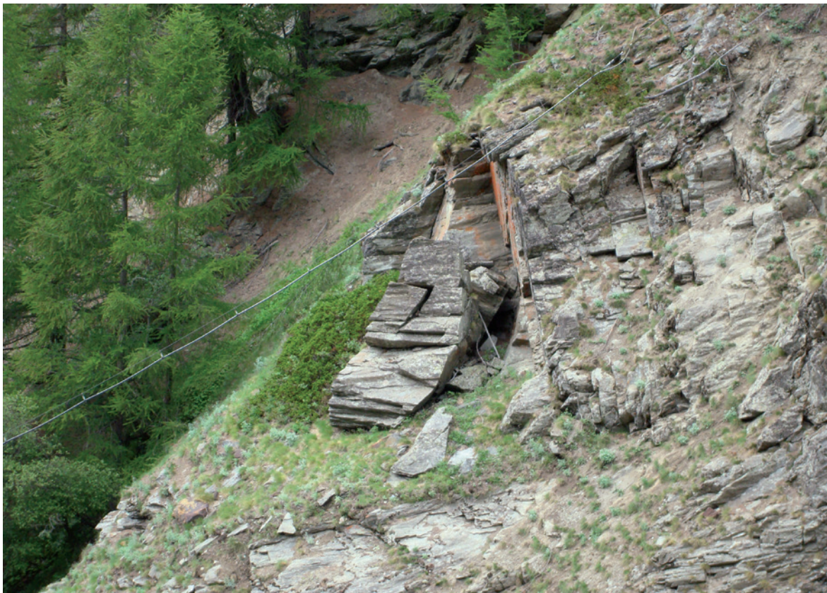
Abb. 1-1: Ein abgerutschter Felsblock verwittert in kleinere Teile und droht früher oder später abzustürzen (Grabengufer, Randa VS).
