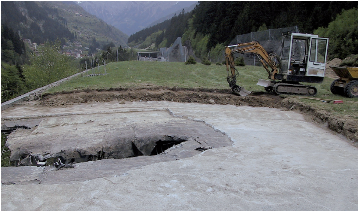
Abb. 4-3: Durchschlagenes Dach der Lawinengalerie Ripplistal bei Gurntellen UR.
