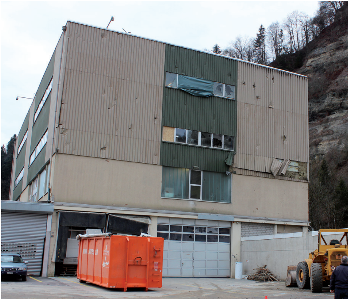
Abb. 4-8: Nordfassade des Industriegebäudes mit den Schadstellen Nr. 1 bis 4 (Badfluh, Wolhusen LU).
