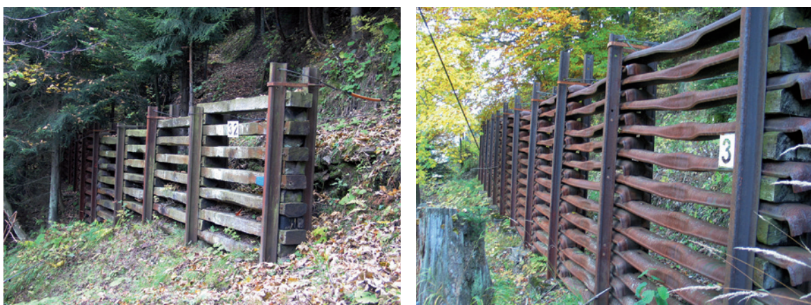
Abb. 6-1: Schutzwände gegen Steinschlag aus Holz- und Stahlschwellen der SBB (Giof, Quinto TI).
