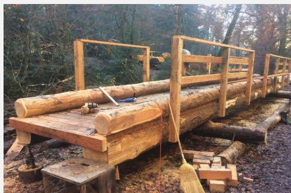
Fig. 1 Passerelle en bois rond (Source SFN)
